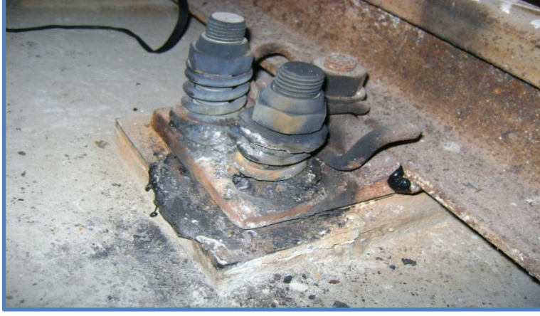
Şekil 6.11 : Kaçak akımdan dolayı yanan Vossloh Sistem 336 tip bağlantı sistemi.
