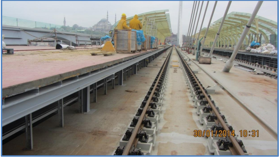
Şekil 6.16 : Haliç Metro Geçiş Köprüsü üzerinde Pandrol Vanguard bağlantı sistemi.
