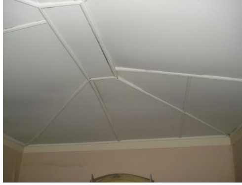
Şekil B.60 : Kuzeydoğu balkonu ve sonradan eklenen tavan kaplaması.
