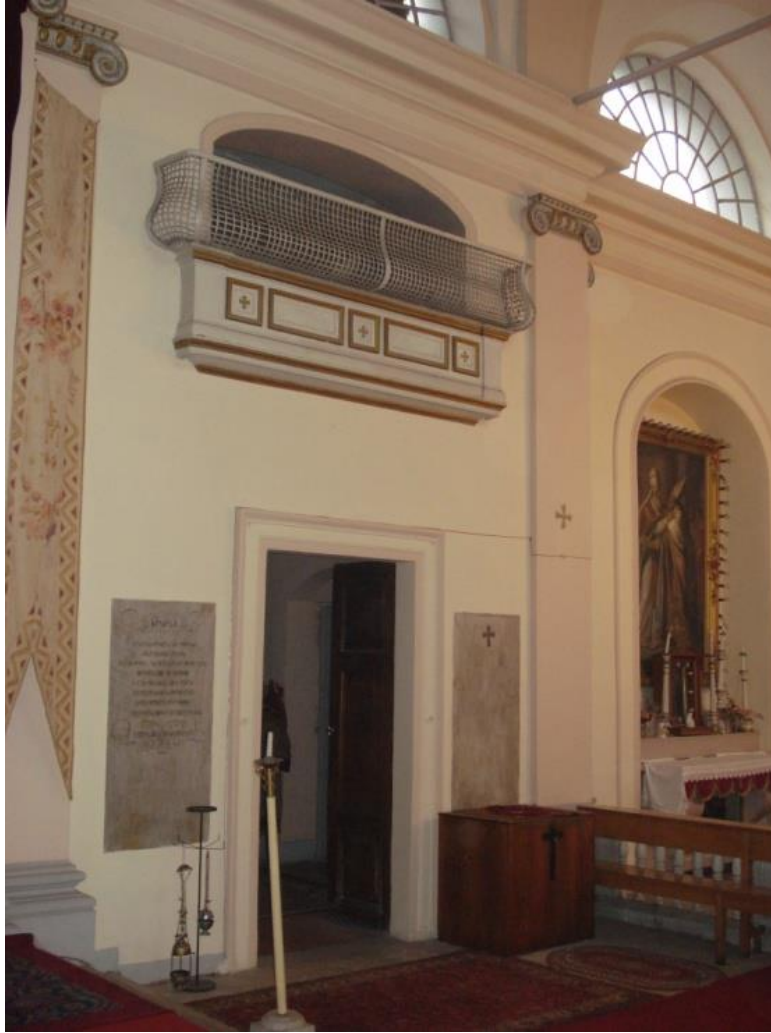
Şekil B.26 : Kuzeydoğu balkonu ahşap ve metal korkuluk.
