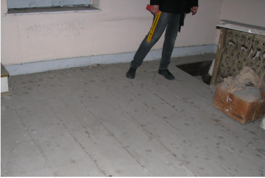
Şekil B.62 : Güneybatı balkonu zemin kaplaması.
