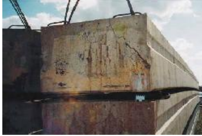
Şekil 2.3. Gecikmiş etrenjit (DEF) oluşumunun meydana geldiği bir adet prefabrik betonarme eleman (Baradan vd., 2002)
