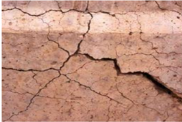
Şekil 2.4. Alkali silika reaksiyonu (ASR) sonucunda zarar görmüş beton eleman (Anonim, 2013)
