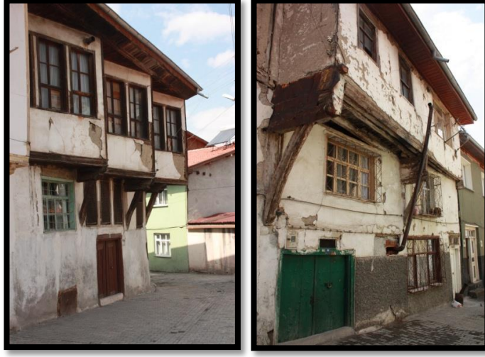
Şekil 85-86: Beyhamam Sokak, 71 Ada, 60-61/62 Parsel Cephe Sıva Bozulmaları
