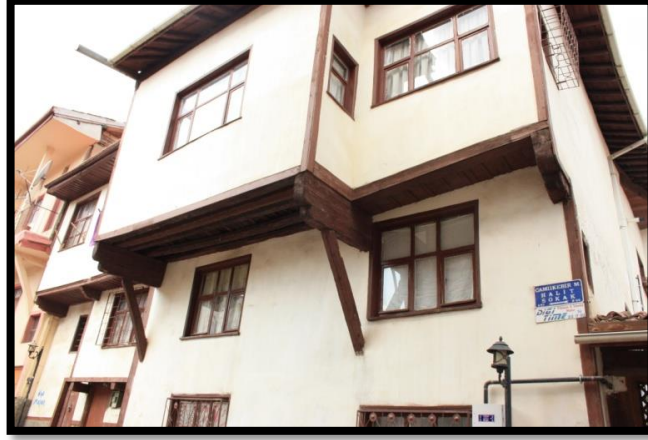
Şekil 84 : Halit Sokak, 241 Ada, 1 Parsel deki Konutun Ön Cephe Sehim Yapmış Çıkması
