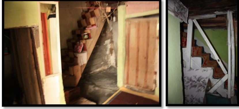
Şekil 97-98 : Halit Sokak, 243 Ada, 16, 240 Ada, 3 Parseldeki Konutlarda Bozulmaya Uğramış Merdivenler
