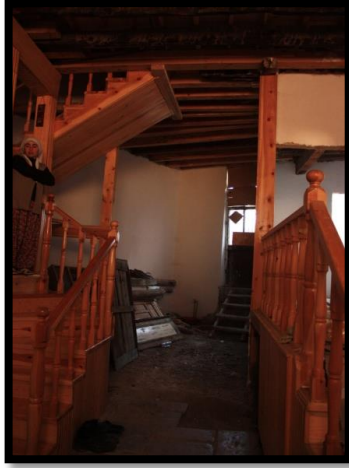
Şekil 76: Halit Sokak, 133 Ada, 109 Parseldeki Konutta Yapılan Ek Merdivenler
