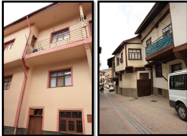
Şekil 80-81: Halit Sokak, 241 Ada- 4 ve 243 Ada- 6 Parsel Konut Ön Cephesindeki Muhdes Balkon
