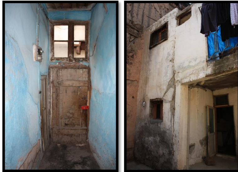
Şekil 95-96: Halit Sokak, 242 Ada 7, 243 Ada, 15 Parseldeki Konutların Kapılarındaki Bozulmalar
