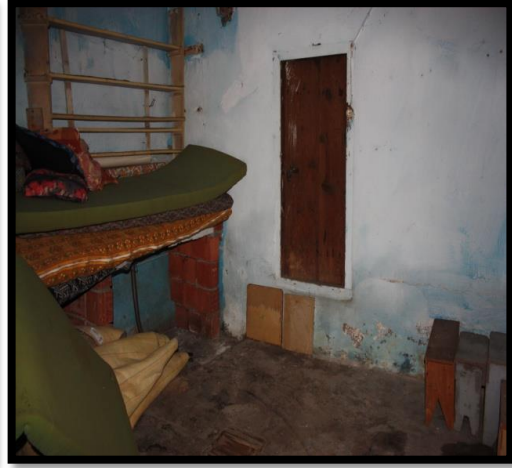
Şekil 77: Halit Sokak, 133 Ada, 109 Parseldeki Konutta Kapatılan Kapı
