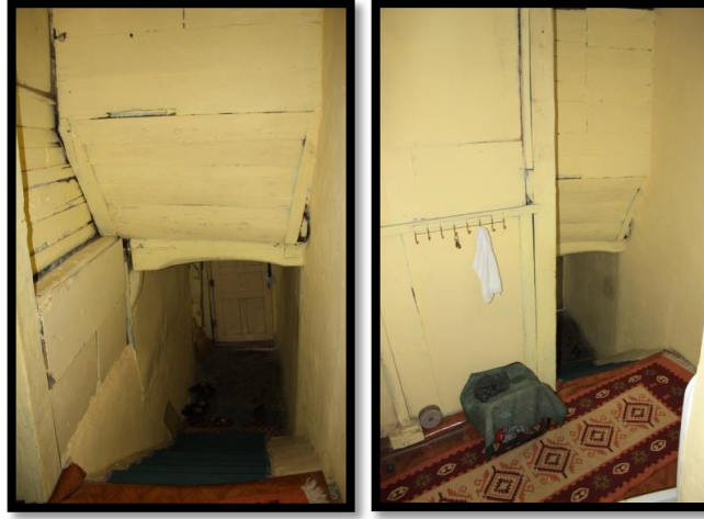
Şekil 72-73 : Halit Sokak, 241 Ada, 1 Parseldeki Konutta Kapatılıp Değiştirilen Merdiven
