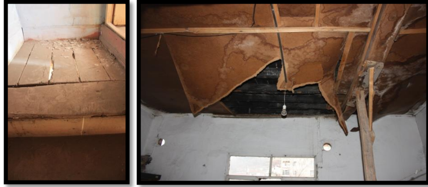
Şekil 91-92: Tokat Behzad Caddesinde Bir Konutun Döşeme ve Tavan Kaplamasındaki Bozulma
