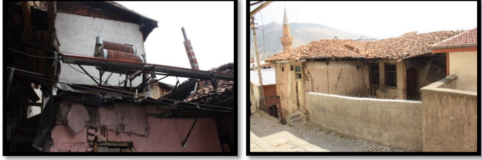
Şekil 89-90 : Halit Sokak, 241 Ada 1 , 242 Ada 1 Parsel Üst Örtü Sistemi Zarar Görmüş Konutlar
