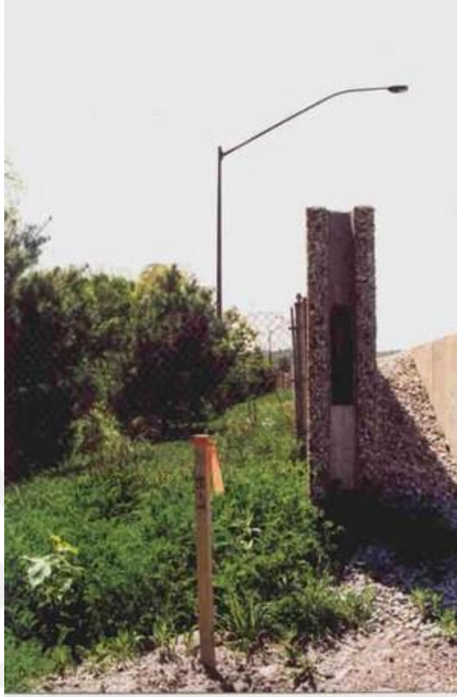
Şekil 3.15 : Toprağı kısmen tutmak için kullanılan ses duvarı [78].
