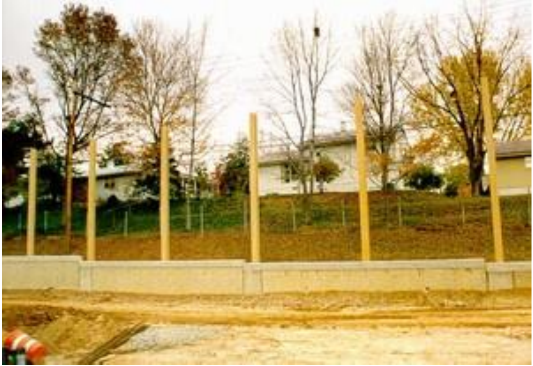
Şekil 3.18 : İstinat duvarına monte edilen ses bariyeri [78].
