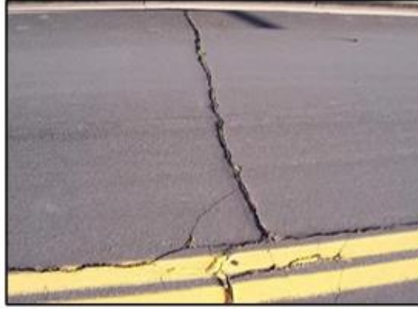
Şekil 2.21: Düşük ısı çatlağı [26].
