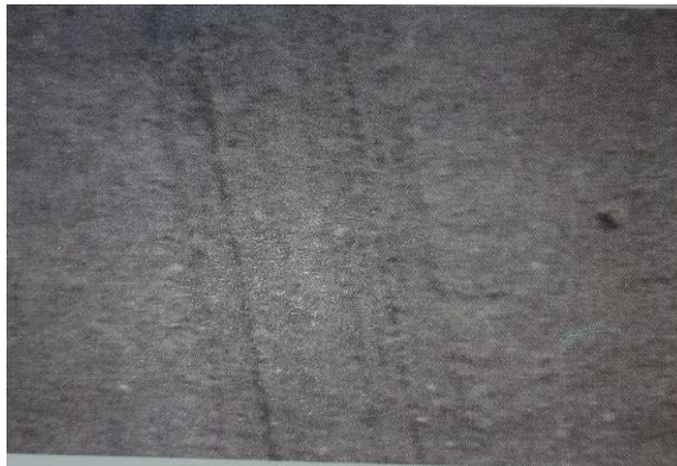
Şekil 2.22: Kaplama üzerinde oluşan kuma [13].
