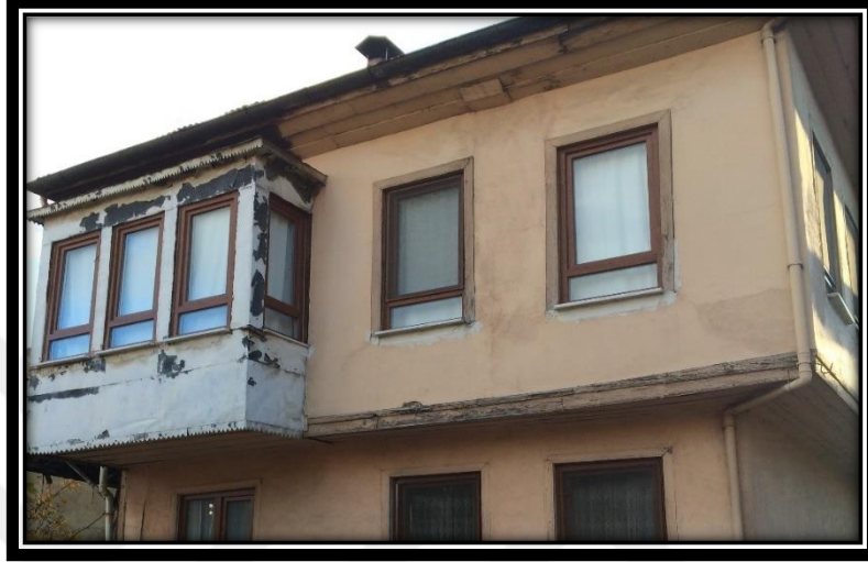
Őekil 4.211. 21 numaralı konutun kuzey cephesinde yer alan ıkma
