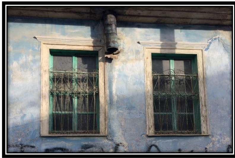
Şekil 4.549. 70 numaralı konutun zemin kat pencerelerinin üzerindeki metal parmaklıklar
