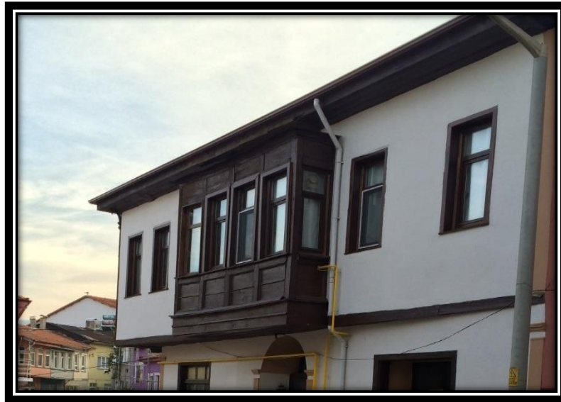
Şekil 4.306. 35 numaralı konutun dođu cephesinde ana giriř kapısı zerinde yer alan ıkması
