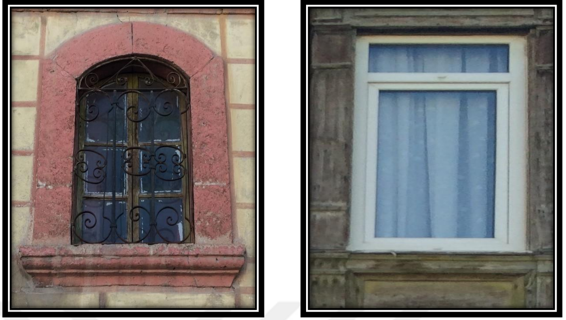
Şekil 4.181. 17 numaralı konutun zemin (solda) ve birinci kat (sağda, PVC ile değiştirilmiş) pencere örnekleri
