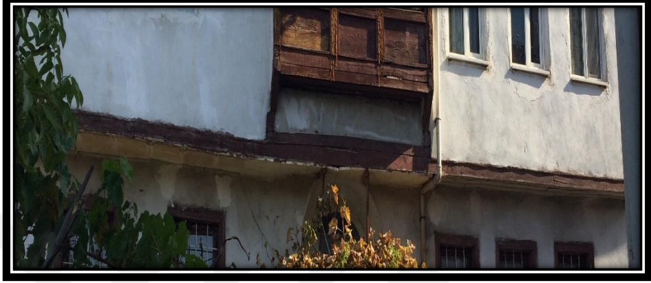
Şekil 4.349. 41 numaralı konutta çıkma altında yer alan kat silmesi niteliğindeki ahşaplar
