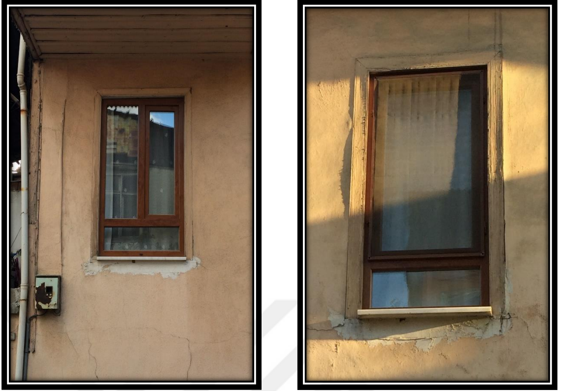
Şekil 4.209. 21 numaralı konutun zemin (solda) ve birinci kat (sağda) PVC malzeme ile değiştirilmiş pencere örnekleri
