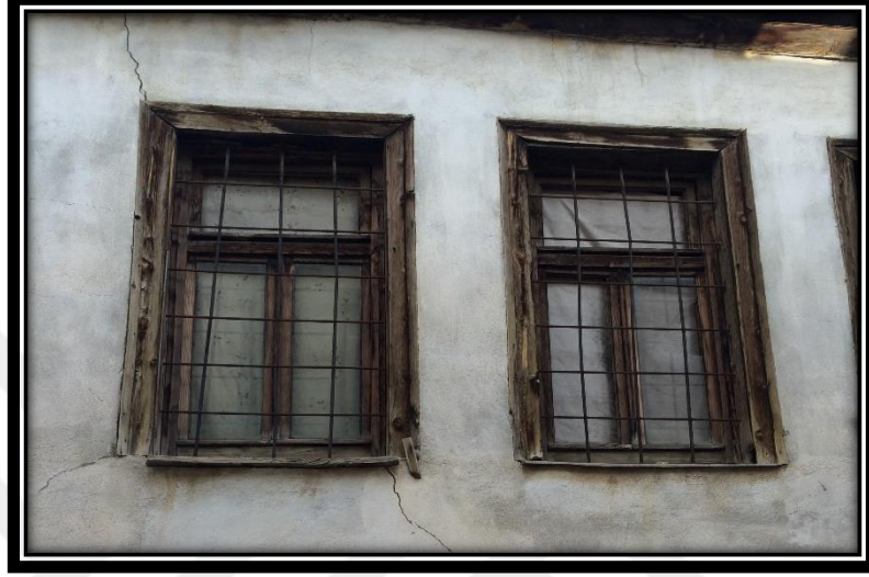
Şekil 4.190. 18 numaralı konutun birinci kat pencerelerinin bazılarında yer alan metal parmaklıklar
