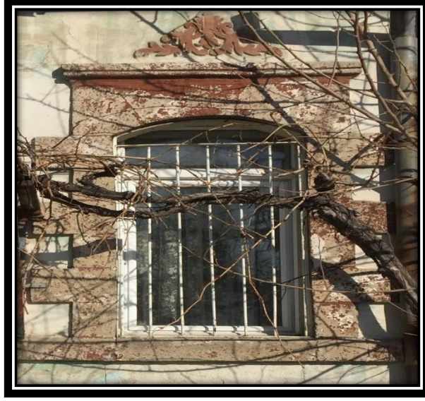
Şekil 4.144. 12 numaralı konutun zemin katının ön cephesinde PVC malzeme ile değiştirilmiş pencere örneği
