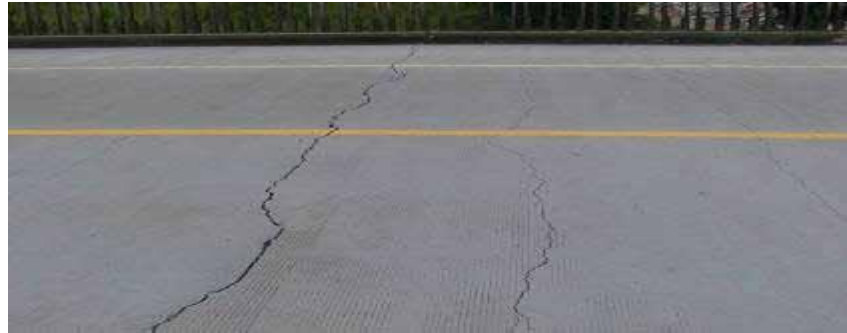
Şekil 2.32 Enine çatlama (IOSR-JMCE 2015)
