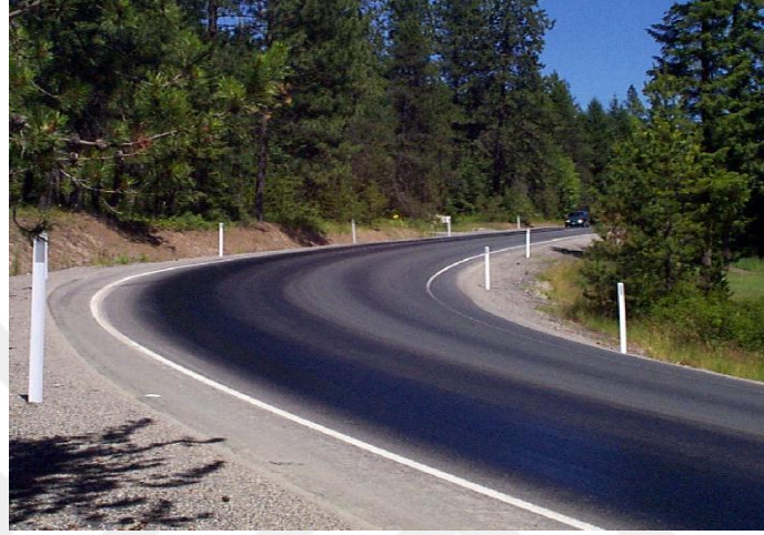
Şekil 2.43 Aşırı asfaltlama sonucu kanama (IOSR-JMCE 2015)
