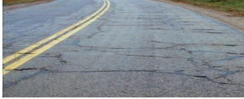
Şekil 2.33 Blok çatlaması (IOSR-JMCE 2015)
