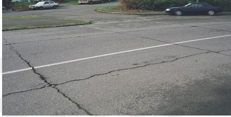
Şekil 2.35 Ana arterde çatlaklar (IOSR-JMCE 2015)
