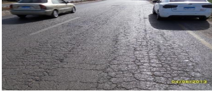
Şekil 2.30 Yorulma çatlaması (Timsah çatlaması)(IOSR-JMCE 2015)
