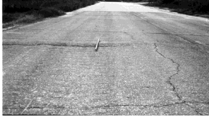
Şekil 2.39 Asfalt kaplamadaki kabarma (IOSR-JMCE 2015)
