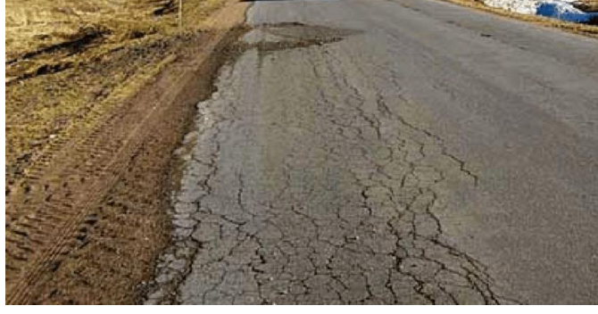
Şekil 2.36 Asfalt kaplamada kenar çatlaması (IOSR-JMCE 2015)
