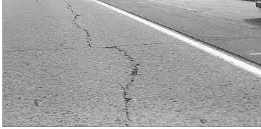
Şekil 2.31 Boyuna çatlak (IOSR-JMCE 2015)
