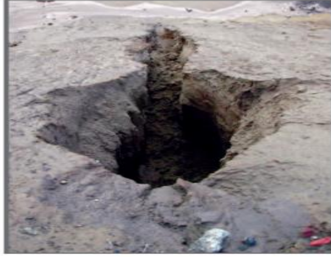
Şekil 2.28 Erozyon (Road Research Center Brussels 1965)
