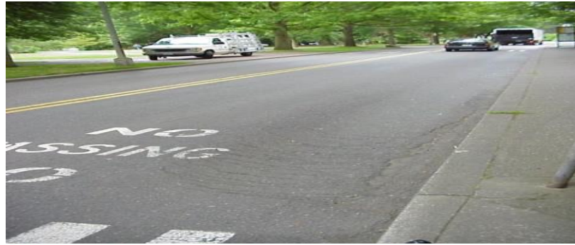
Şekil 2.34 Bir otobüs durağında kayma çatlaması (IOSR-JMCE 2015)
