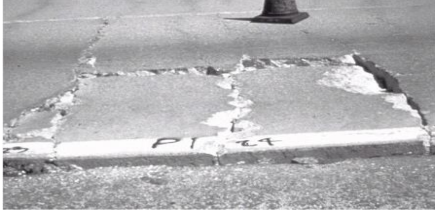
Şekil 2.27 Su kaynaklı “Punchout” fenomeni (Road Research Center Brussels 1965)
