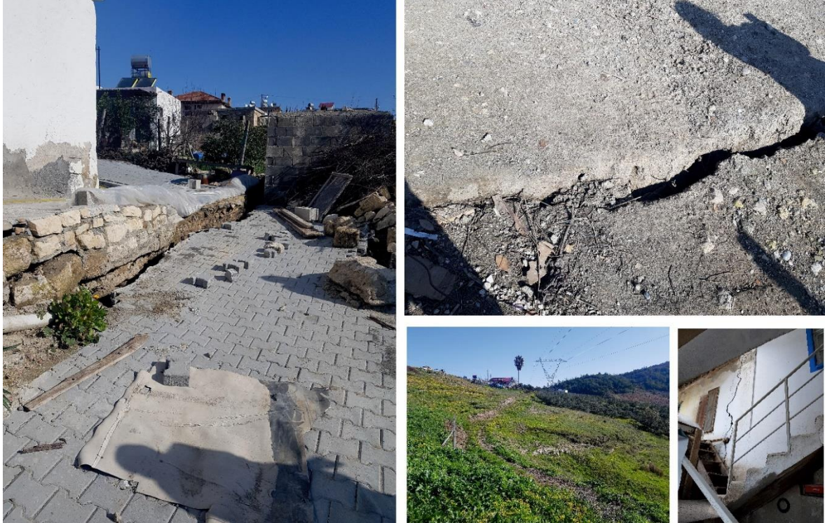
Şekil 3.13. Bağcılar Mahallesi heyelan bölgesi.
