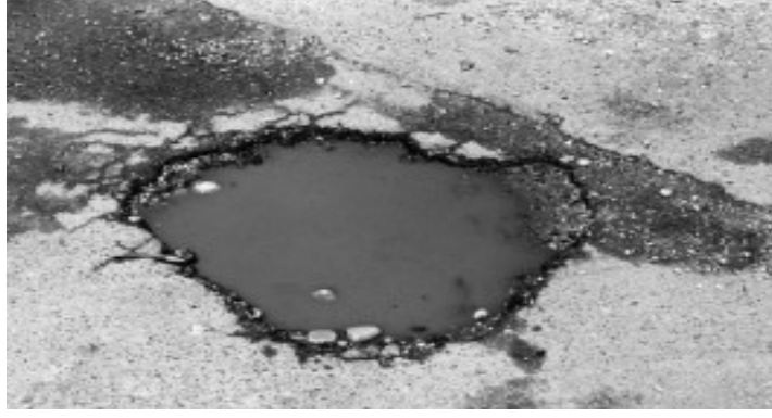
Şekil 3.25. Esnek kaplamada oluşan folluk tipi oyuklar
