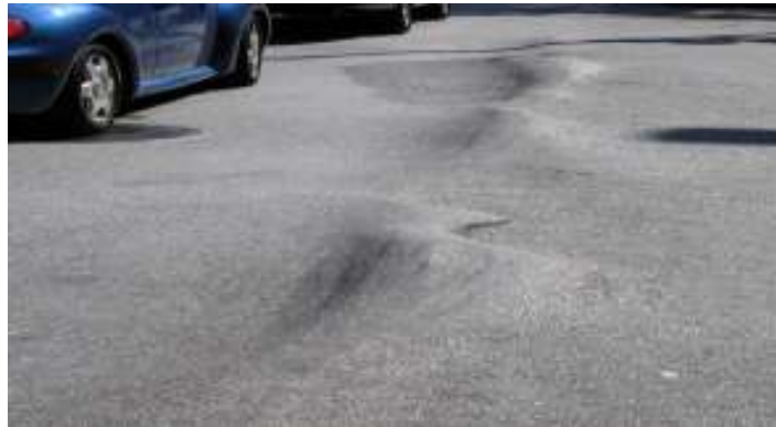
Şekil 3.14. Esnek kaplamada oluşan yığılmalar
