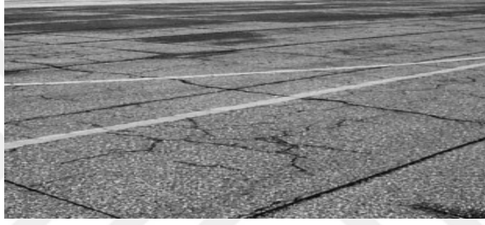
Şekil 3.18. Esnek kaplamada oluşan yansıma çatlakları
