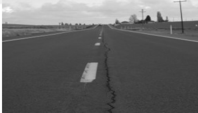
Şekil 3.22. Esnek kaplamada oluşan derz çatlakları
