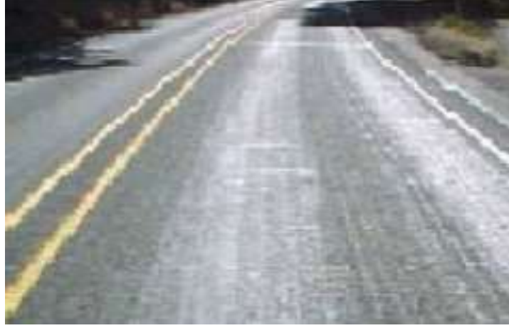
Şekil 3.11. Esnek kaplamada oluşan lastik deseni
