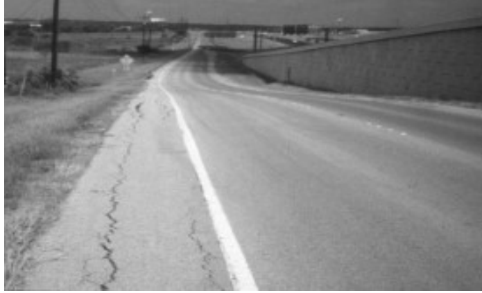
Şekil 3.21. Esnek kaplamada oluşan kenar çatlakları
