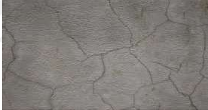
Şekil 3.20. Esnek kaplamada oluşan düşük sıcaklık çatlakları
