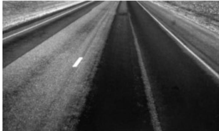
Şekil 3.26. Esnek kaplamada oluşan sökülmeler
