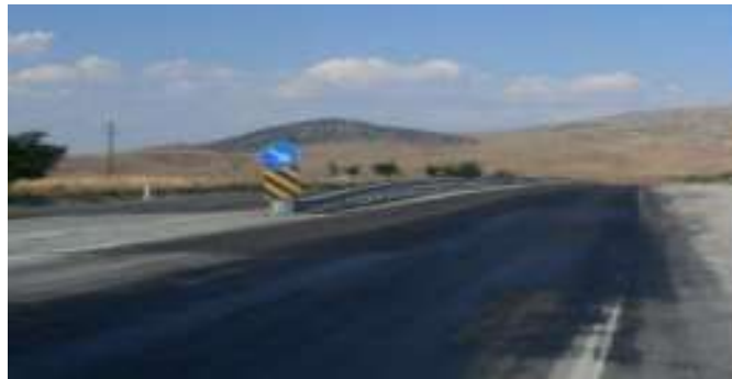
Şekil 3.29. Esnek kaplamada oluşan kusma
