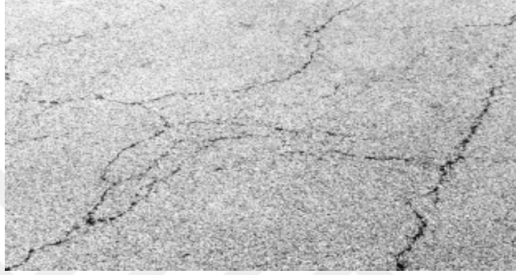
Şekil 3.16. Esnek kaplamada oluşan stabilite çatlakları
