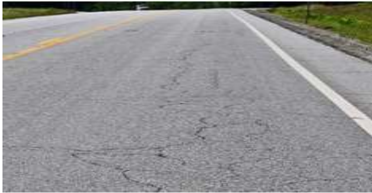
Şekil 3.17. Esnek kaplamada oluşan yorulma çatlakları
