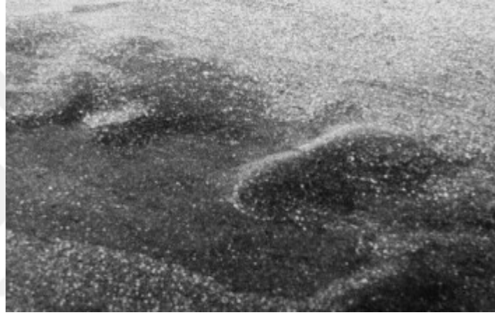
Şekil 3.15. Esnek kaplamada oluşan kabarmalar
