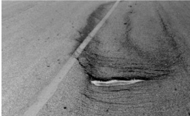
Şekil 3.24. Esnek kaplama oluşan yüzey kayması çatlakları
