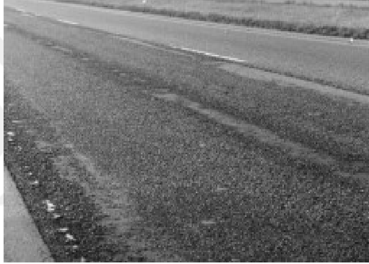
řekil 3.27. Esnek kaplamada oluřan soyulma
