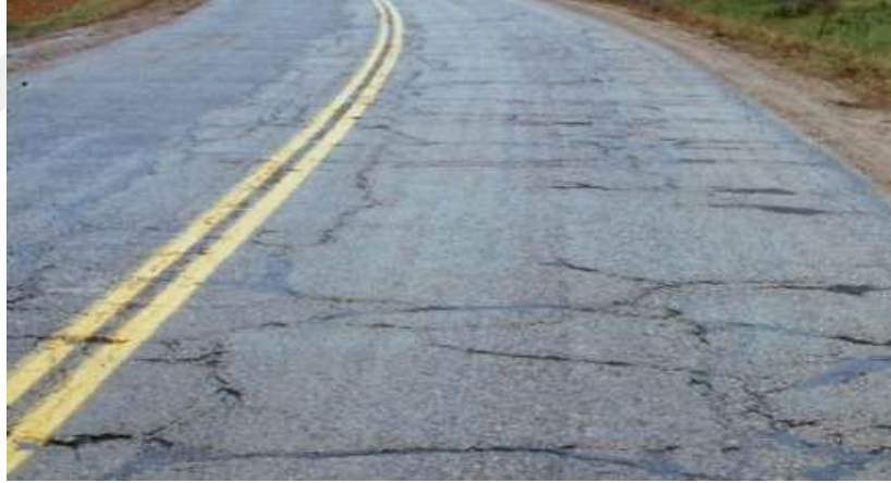
Şekil 3.9. Esnek kaplamada oluşan üniform olmayan yüzey bozukluğu
