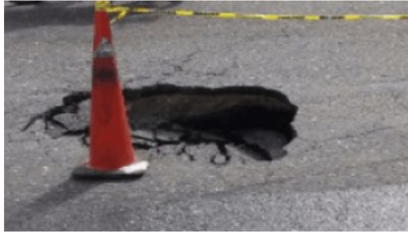
Şekil 3.12. Esnek kaplamada oluşan bölgesel çökme
