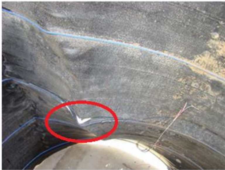
Şekil 7.2 Dolgudan kaynaklanan yapısal hasarlar (Masajedian 2011)
