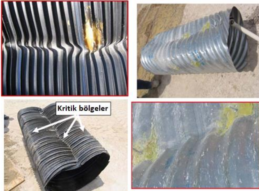
Şekil 7.3 Korige HDPE ve çelik boruda için tacındaki yapısal hasarlar
