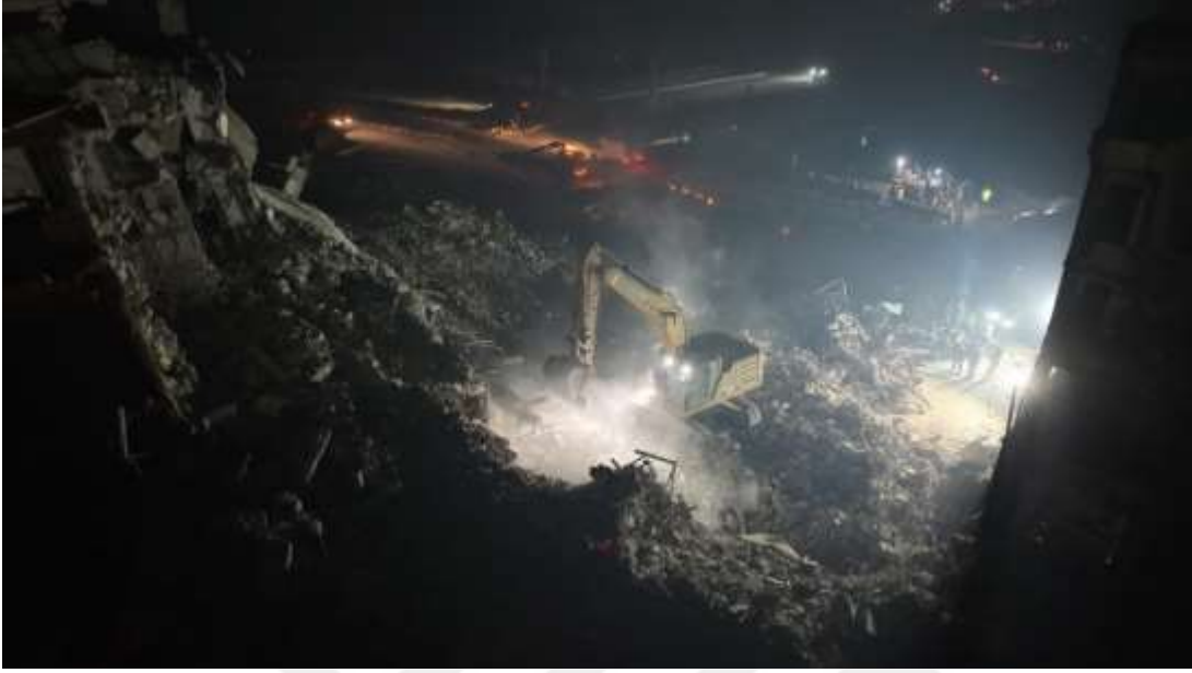
Şekil 3.3. Hatay’da yürütülen enkaz çalışmalarının bir görüntüsü Kaynak: Fotoğraf: Elmas, A. (2023). Hatay’daki enkaz çalışmaları. [Fotoğraf]. Kişisel arşiv.
