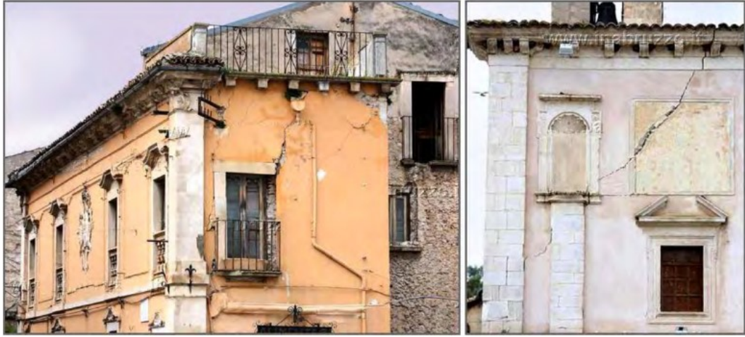
Şekil 2.7. Deprem nedeniyle oluşan diyagonal çatlaklar (Capozucca, 2008)
