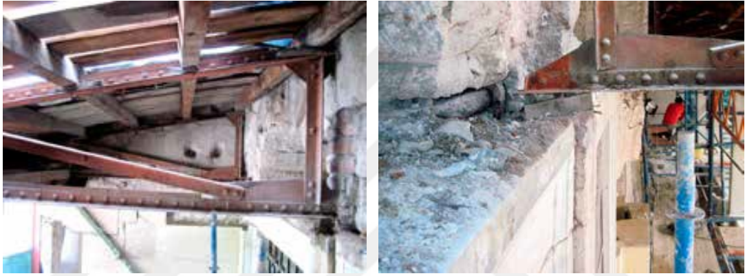
Şekil 3.24a. Ahşap çatı söküldüğünde ortaya çıkan demir makaslar b. Statik olarak zayıflamış demir makaslara yapılan eklerle güçlendirme (Ceylan ve Ocakcan,2013).
