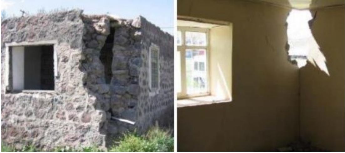
Şekil 2.13. Köşe birleşimindeki hatalardan kaynaklı hasarlar (Bayraktar vd, 2007).
