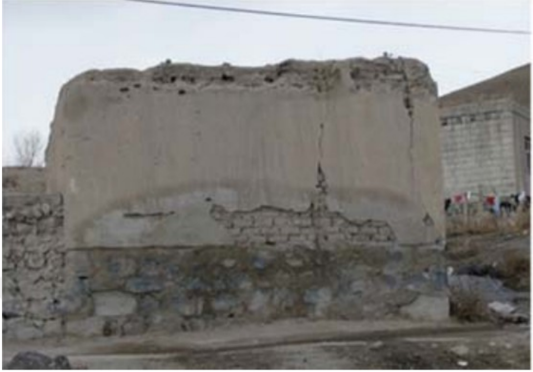
Şekil 2.2. Statik durumda zati yüklerin sebep olduğu düşey çatlaklar (Oyguç, 2017)
