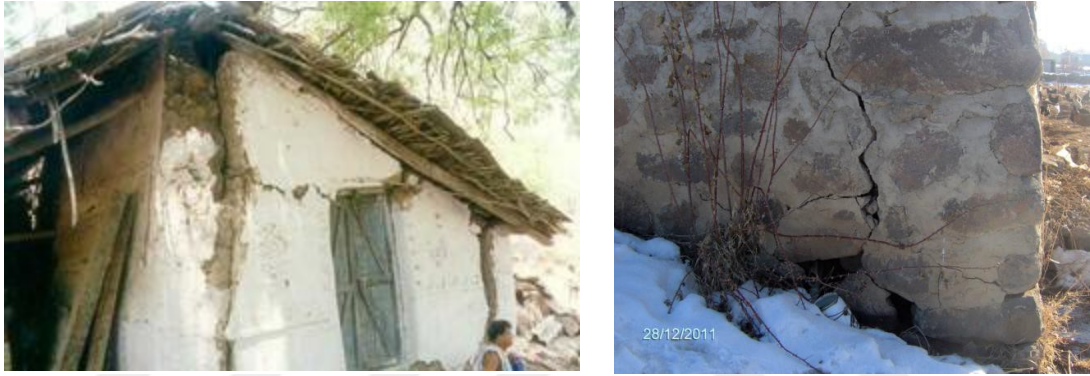
Şekil 2.14. Yığma yapıda köşe ayrılması köşe ayrışması (2011 Van depremi) (Alıcıoğlu, 2012)
