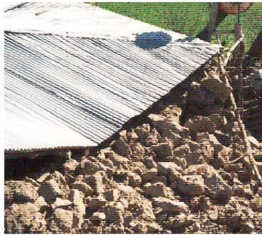
Şekil 2.10. Moloz taş duvarın yıkılması (Batur, Kaplan, 2006)
