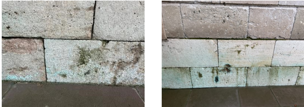
Şekil 2.19. Bimarhane ön cepheindeki duvarlarda tuzlanmalar ve renk değişimleri
