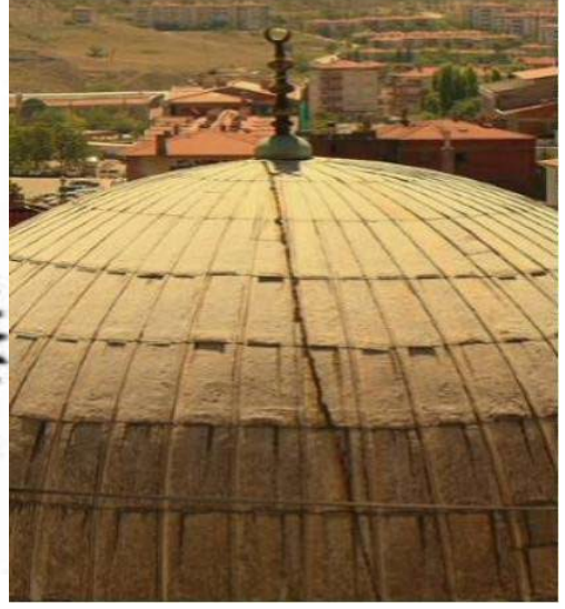
b) Kubbede oluşan hasar
