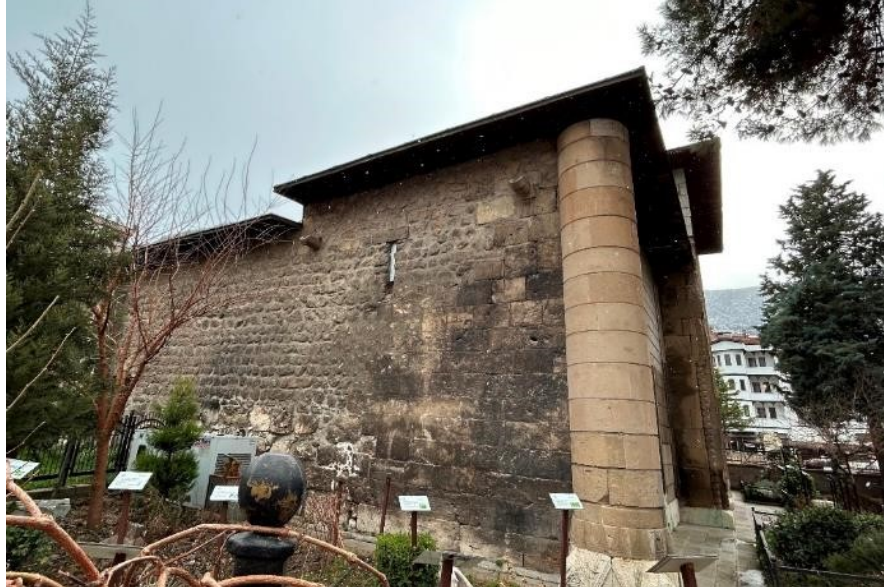
Şekil 2.20. Bimarhane'nin kuzey cephesinde oluşan siyah kabuk oluşumu
