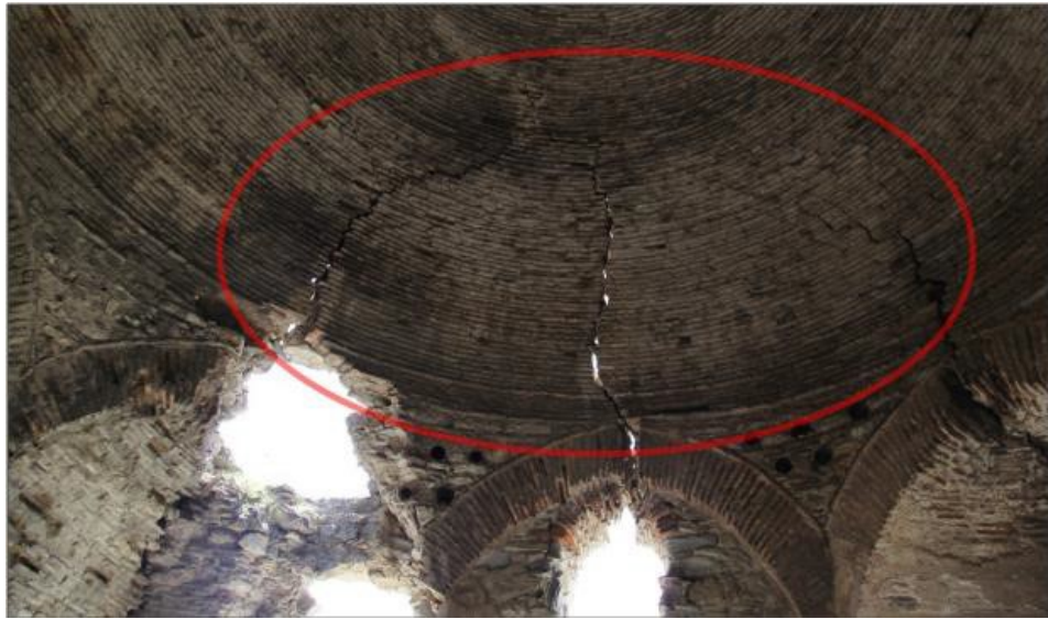
Şekil 2.16. Urla Helvacılar Camindeki eksenel kubbe hasarı (Güzel, 2019)
