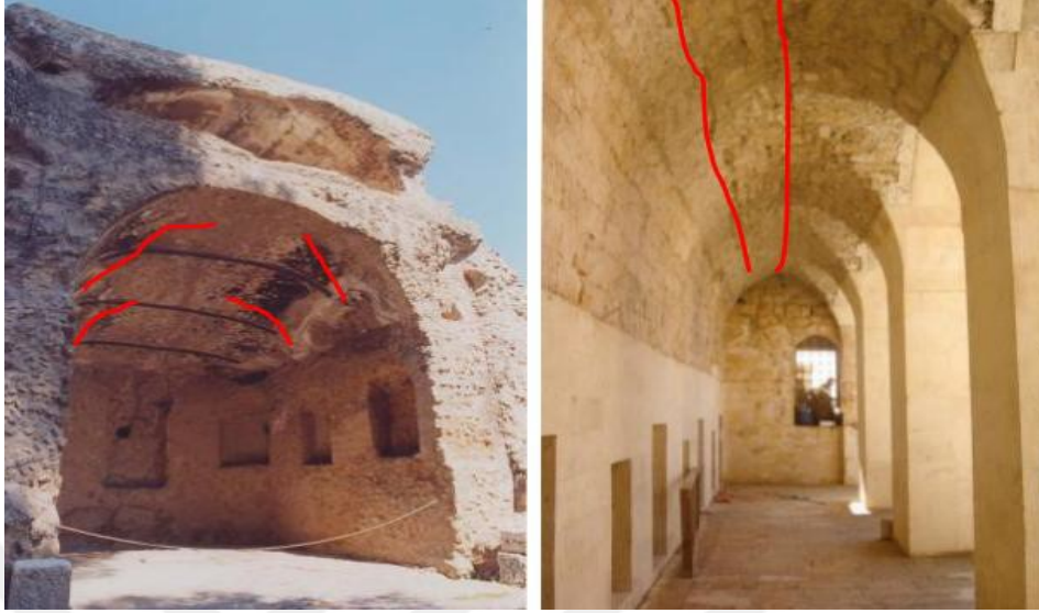
Şekil 2.18. Tonozlarda oluşan çatlak tipleri (Döndüren ve diğerleri, 2017).
