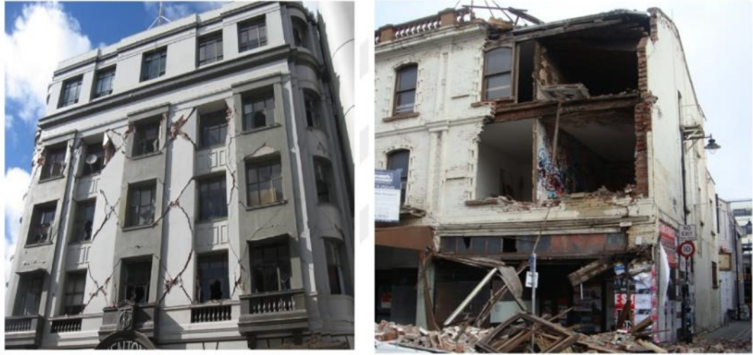
Şekil 2.9.(a) Düzlem içi x çatlakları (b) Düzlem dışı göçme (Lin, 2013)
