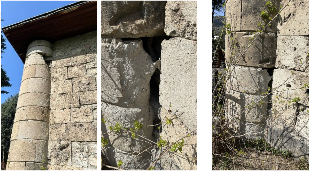
Şekil 5.63. Giriş cephesi ile güney duvarının birleşim bölgelerindeki ayrışmalar
