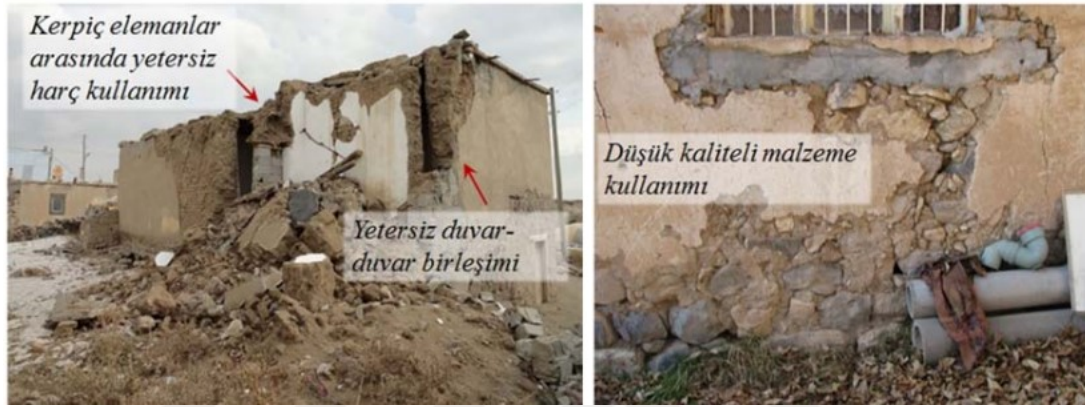
Şekil 2.12. Kerpiç duvarda görülen hasarlar (Oyguç (2017))
