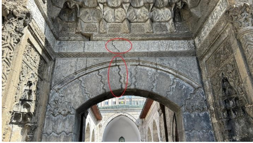
Şekil 5.62. Giriş kapısının kemerinde ve üzerindeki kitabede görülen çatlaklar
