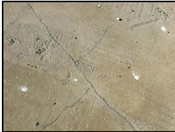
Şekil 1.4. Plastik rötre çatlak örneği
