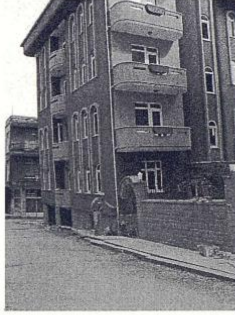
Şekil 6.8 Adapazarı'nda yaklaşık 140 cm'lik farklı oturmaya maruz kalan bina (yaklaşık 10'da 1 veya 5 derece eğim). Bu bina daha sonra yıkıldı. (EEFIT)
