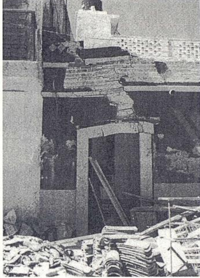
Şekil 4.14 1995 Manzanillo, Meksika depremi sonrasında Jalisco'da hasar gören bir bina (Juarez Garcia vd., 1997).
