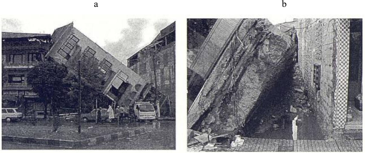
Şekil 6.1 (a) Adapazarı şehir merkezinde sert sığ temeller üzerindeki bir binanın devrilmesi ve (b) aynı binanın temellerinin yakından görünümü (Bray & Stewart. 2000)
