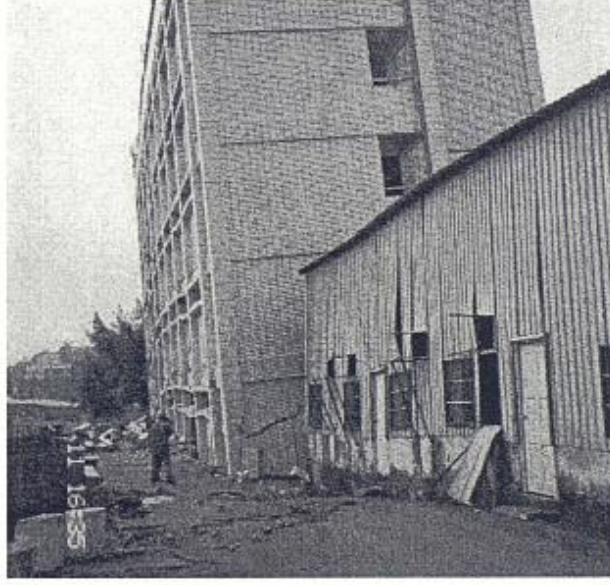
Şekil 6.3 Sıvılaşmadan kaynaklı zemin deformasyonlarının neden olduğu 'yapısal hasar' (Fotoğraf: Marshall Lew, Los Angeles Yüksek Binalar Tasarım Konseyi)
