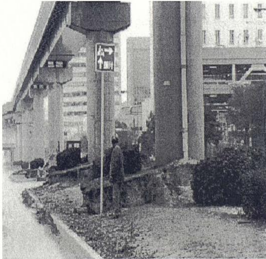
Şekil 4.7 17 Ocak 1995 depreminin ardından Kobe'de yükseltilmiş bir ulaşım bağlantısı (Fotoğraf R.W. Boulanger, UC Davis'in izniyle) Köprü ayakları istiflenmiş olup, yapı genel olarak yerleşime rağmen hasar görmemiştir.
