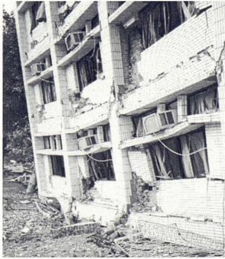
Şekil 4.5 1999 Chi-Chi sonrasında bir teknik okul binasında sıvılaşmanın neden olduğu hasar (Fotoğraf izniyle: Marshall Lew, Los Angeles Yüksek Binaların Yapısal Tasarımı Konseyi)
