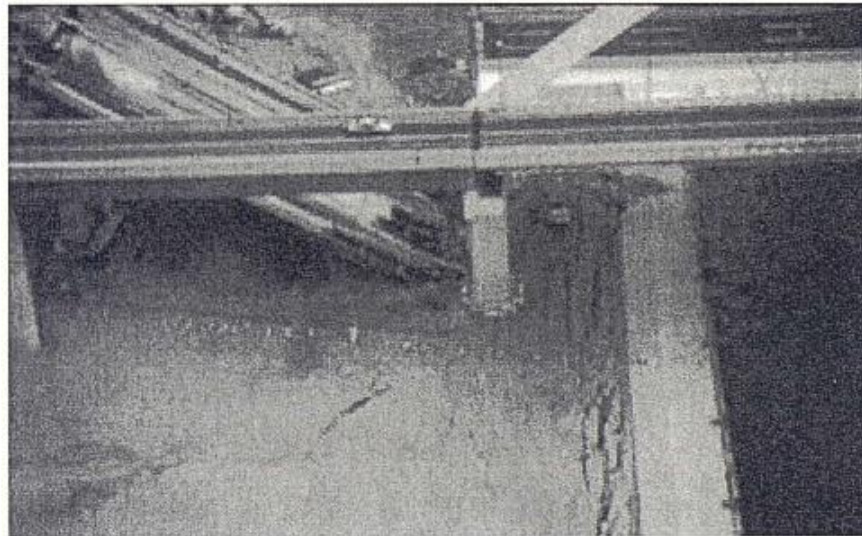
Şekil 4.10 Japonya'da sıvılaşmaya bağlı temel deformasyonlarından kaynaklanan 1999'daki 6,9 Mw Kobe depreminin ardından Nishinomaya Köprüsü'nde meydana gelen çöken açıklık (Fotoğraf: LF. Harder, Jr)
