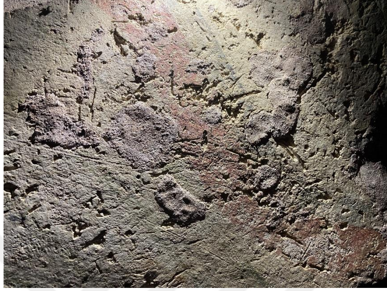
Resim 79: Geçmiş Yıllarda Yüzey Üstüne Taşırılarak Yapılan Yanlış Lakuna Harcı Müdahaleleri (Büşra Al'ın Arşivi 2023)
