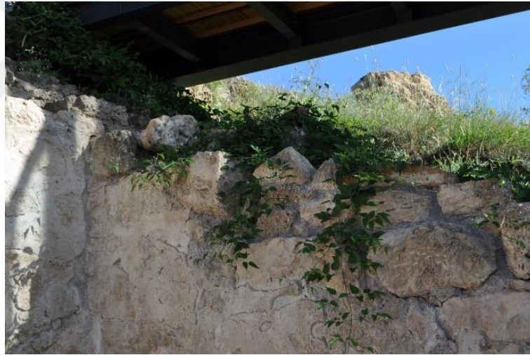
Resim 75: Oda-5 Duvarların Üst Kısımlarında Bitki Oluşumu (Büşra Al'ın Arşivi 2024)
