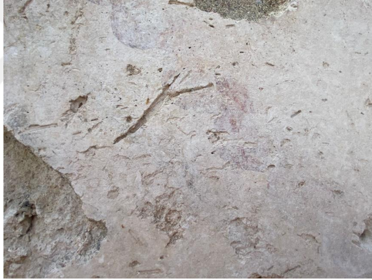
Resim 68: Kırıntı Kullanımından Kaynaklı Oluşan Tahribatlar (Büşra Al'ın Arşivi 2023)
