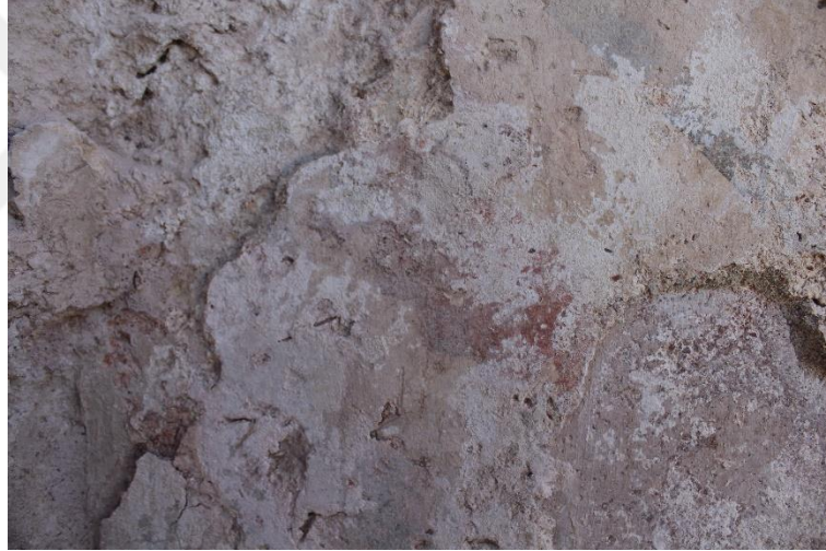
Resim 74: Oda-5'in Batı Duvarı Resminde Yoğun Tuz Oluşumu (Büşra Al'ın Arşivi 2023)
