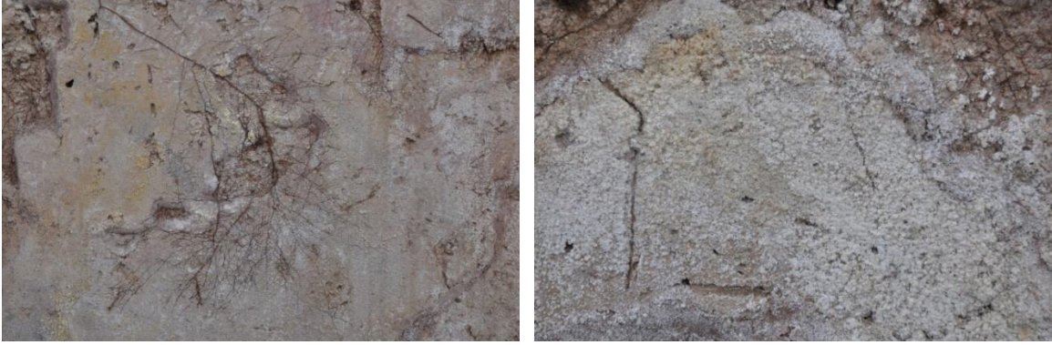
Resim 54-55: Duvar Resmi Yüzeyinde Kılcal Bitki Oluşumu ve Tuzlanma (Kalker) (Büşra Al'ın Arşivi 2020)
