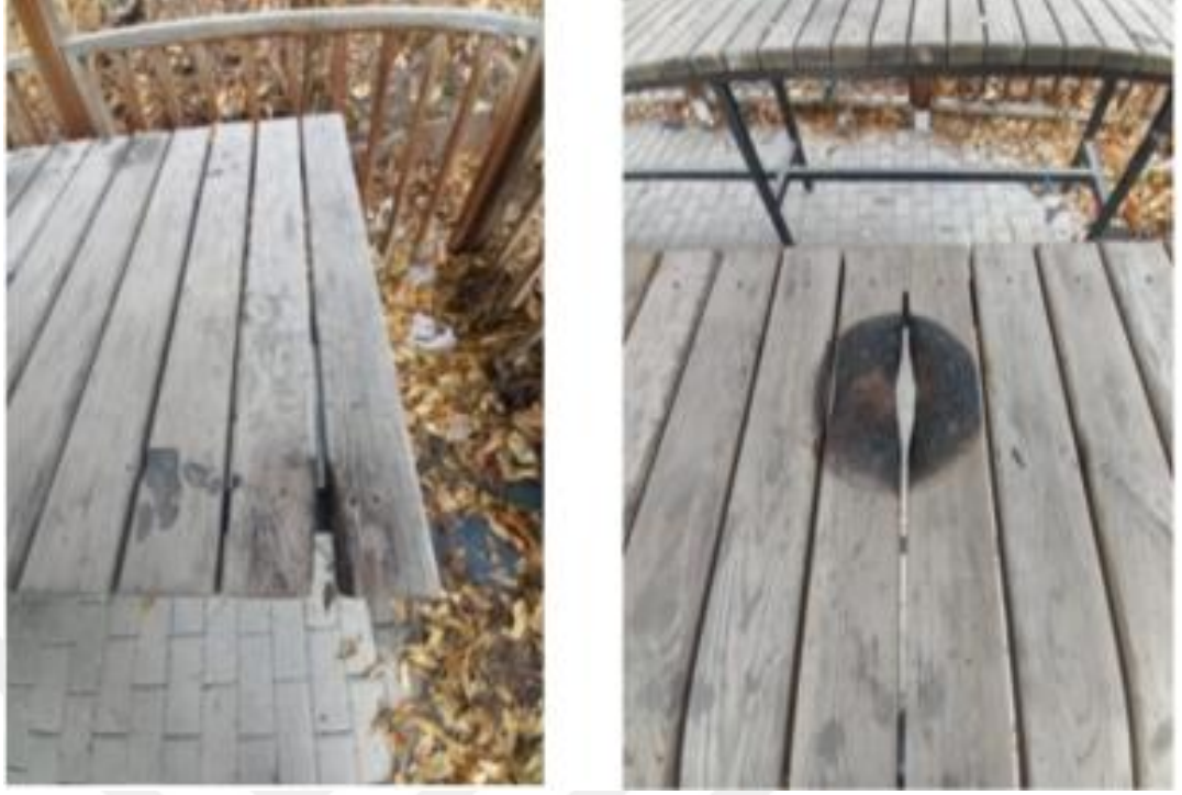
Şekil 4.6 Necmettin Erbakan Parkı'ndaki zarar görmüş oturma elemanları (Orişinal 2023)
