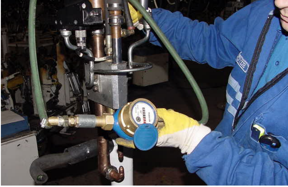
Şekil 5.6 : Soğutma Suyu Debisinin Ölçümü Ve Kontrolü
