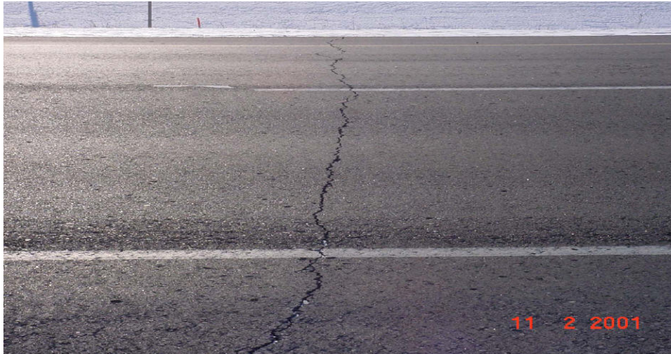
Şekil 2.3 Yüksek Şiddette Enine Çatlak (İsfalt, 2002)
