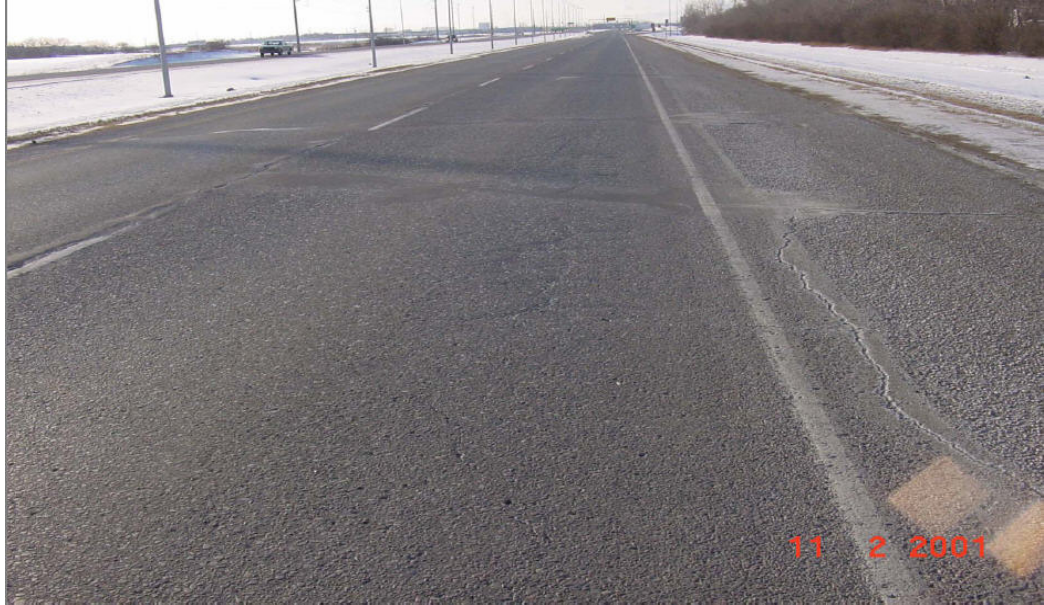
Şekil 2.2 Orta Şiddette Kenar Çatlağı (İsfalt, 2002)
