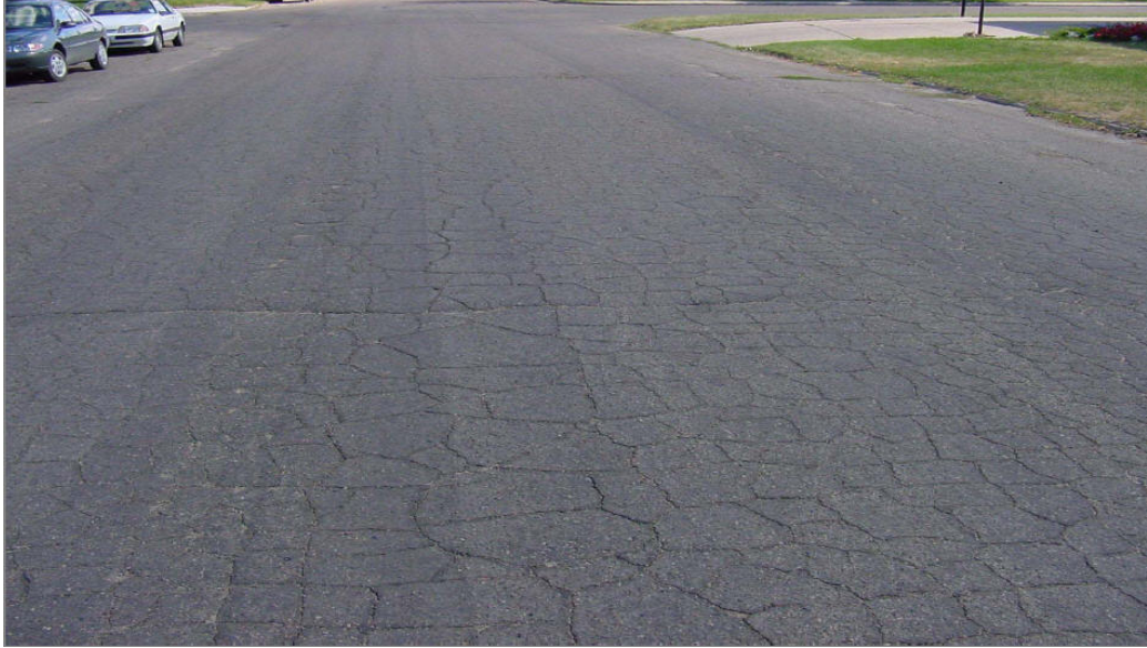
Şekil 2.6 Yüksek Şiddetli Blok Çatlaklar (İsfalt, 2002)
