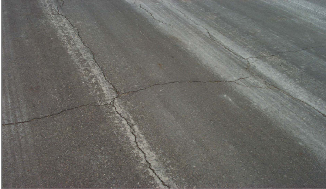
Şekil 2.5 Orta Şiddetli Blok Çatlaklar (İsfalt, 2002)
