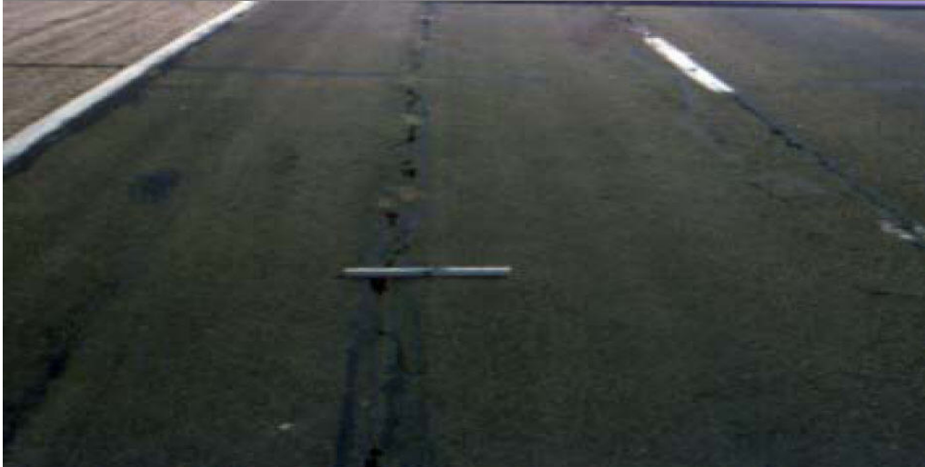
Şekil 2.4 Yüksek Şiddette Boyuna Çatlak (İsfalt, 2002)
