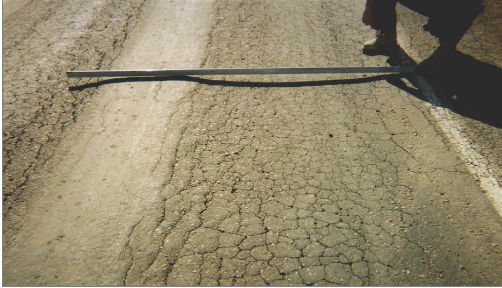
Şekil 2.1 Orta Şiddette Timsah Sırtı Çatlak (İsfalt, 2002)
