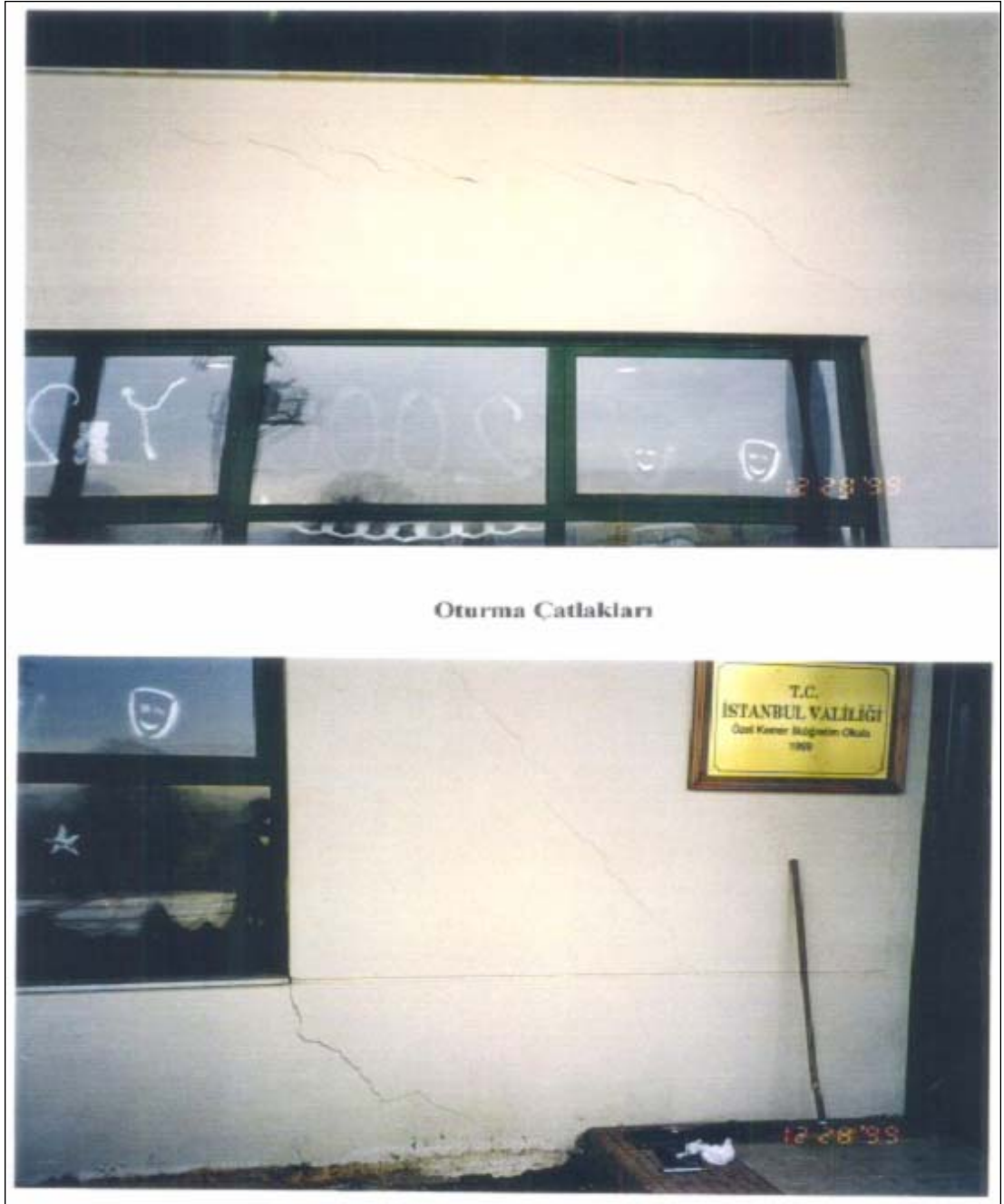
Şekil 4.3 : Binada meydana gelen oturma çatlakları
