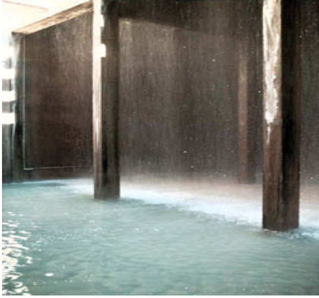
Şekil 2.2. Tesise ait soğutma kulesi havuz kısmı.
