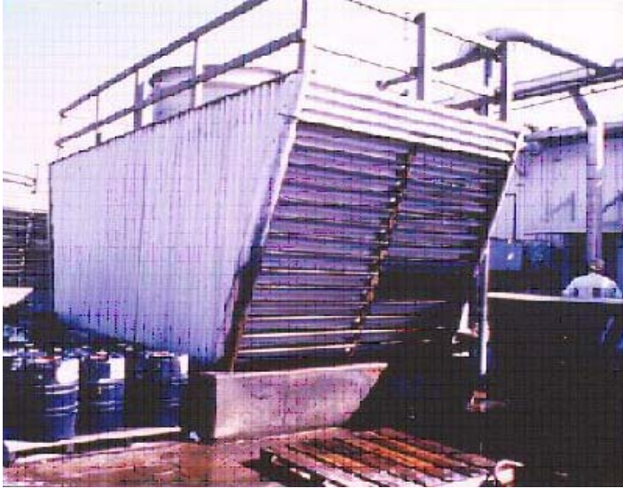
Şekil 2.3. Soğutma kulesinin filtre kısmı.
