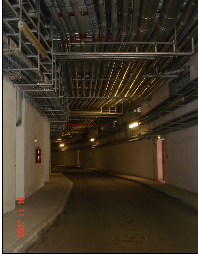
Şekil 3.26. Roma Oditoryum Binası Teknik Servis Bölümü [24]
