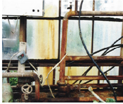
Şekil 3.25. Metal borularda korozyon
