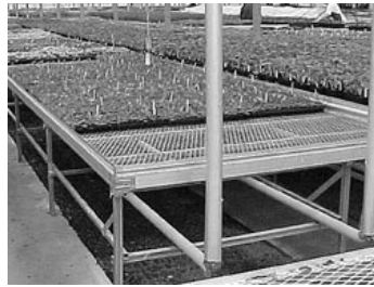
Şekil 2.2. Yetiştirme masalarının altından geçirilen sıcak su boruları (Prenger and Ling, 2000)
