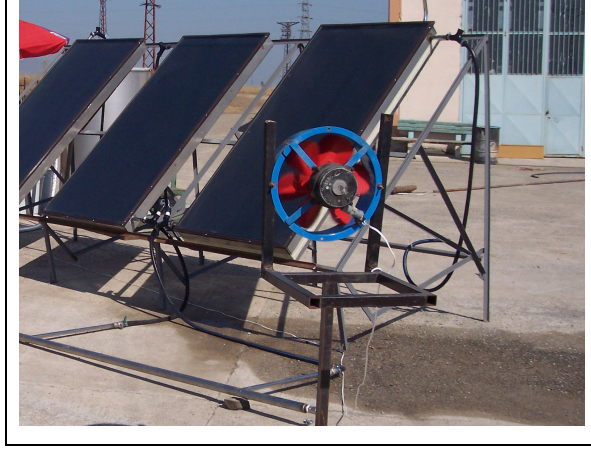
Şekil 3.11. Aksiyal fanların yerleştirilmesi
