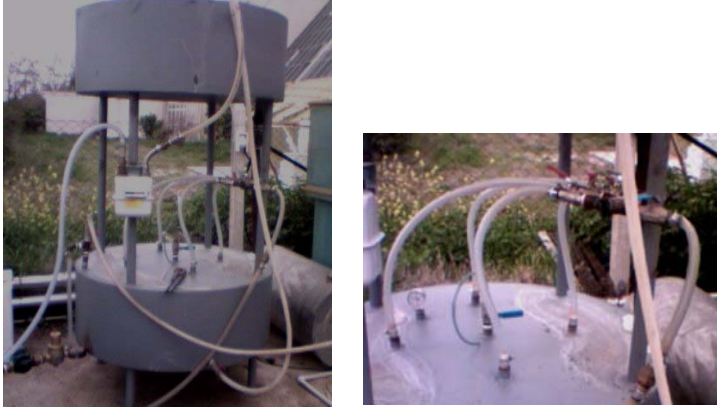
Şekil 3.10 0,5 m 3 hacimli biyogaz depolama tankı ve su dağıtım sistemi
