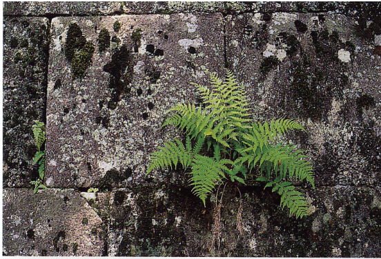
Şekil 3.5. Yosunlanmış taş duvar [58]
