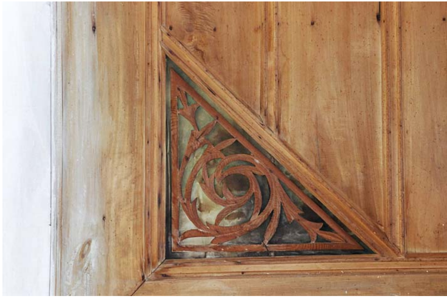
Fotoğraf 322: Tevrüzlü Konağı Toyhane Bölümü, Kilimüstü Tavanı Kuzeydoğu Köşe Üçgen Bezeme Detayı
