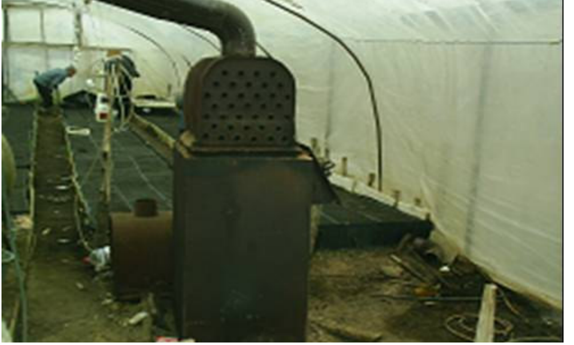
Şekil 4.10. Seralarda sıcak hava ile ısıtma (Koru Köyü)
