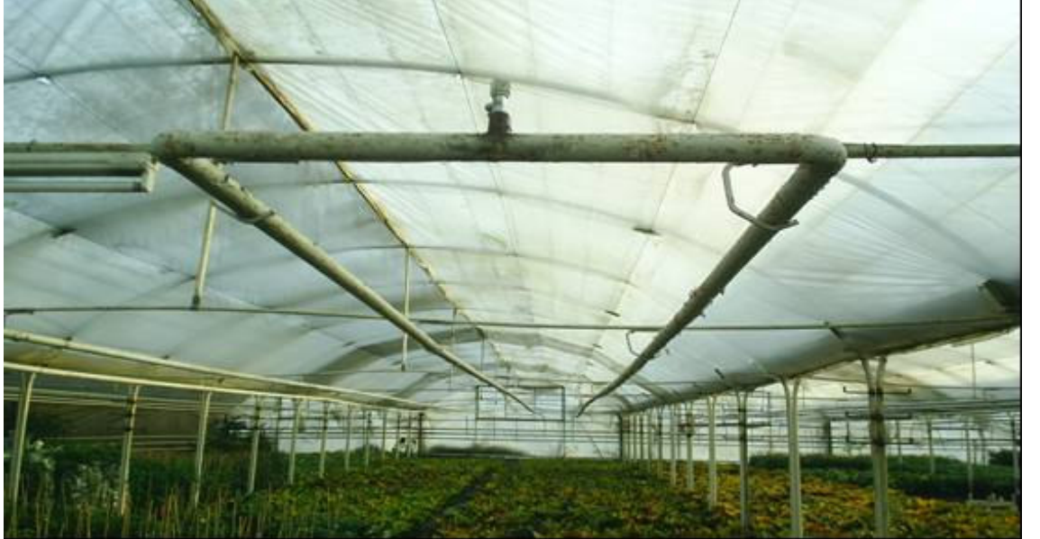
Şekil 4.11. Kaloriferli ısıtma sistemlerinde sera tavanına yerleştirilen ısıtma boruları (Topçular mevki)
