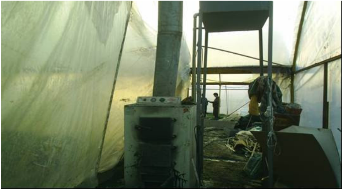
Şekil 4.13. Sera kalorifer sisteminde kullanılan bir ocağın görünüşü (Topçular mevki)
