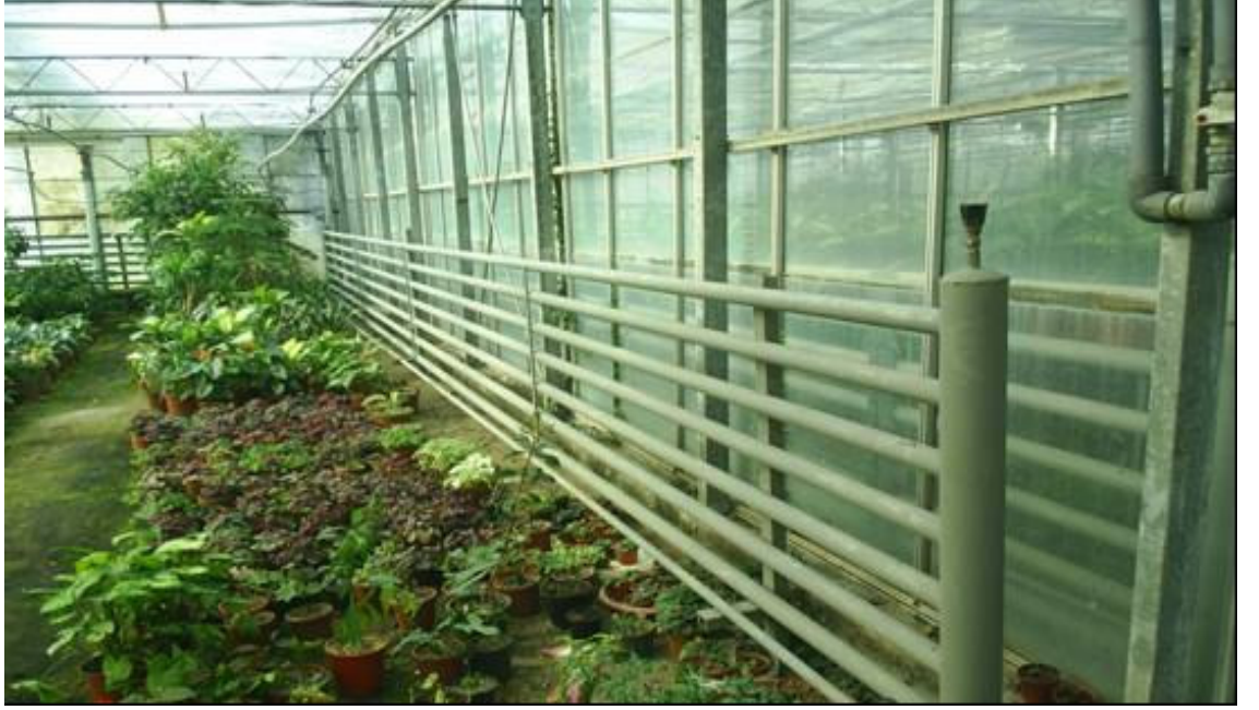
Şekil 4.12. Kaloriferli ısıtma sistemlerinde sera yan duvarlarına yerleştirilen ısıtma boruları (Yalova merkez)
