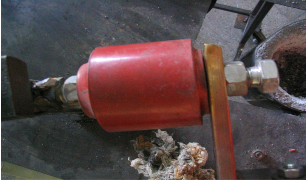
Şekil 3.3.b. İzolatör, bakır bara ve hareket mekanizmasının birleşim fotoğrafı
