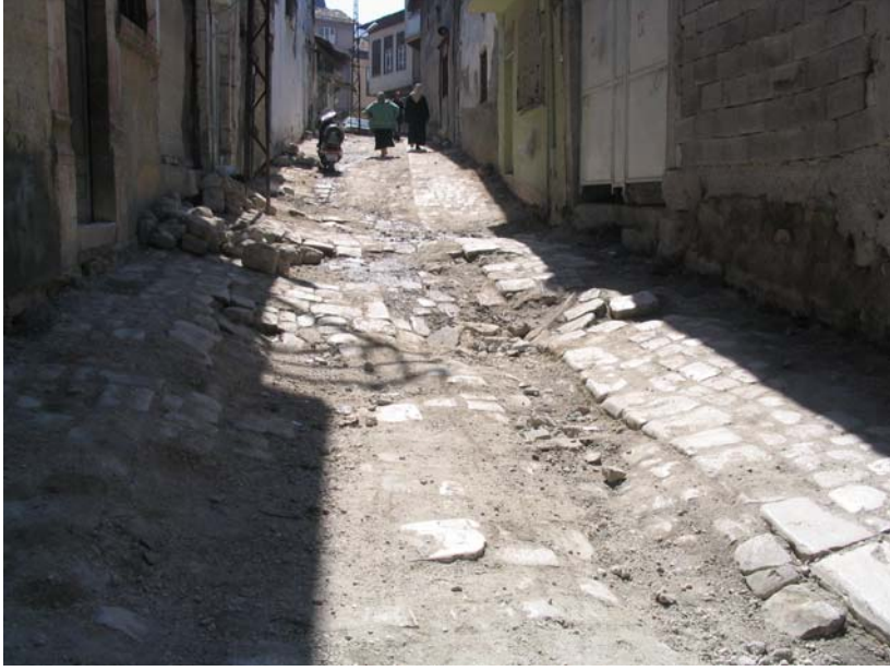
Resim 6.17. Beton altında kalarak çöken tarihi taş kaplamalı sokak (Ulucami Mahallesi-40 Yıllık Türk Yurdu Sokak) [75]
