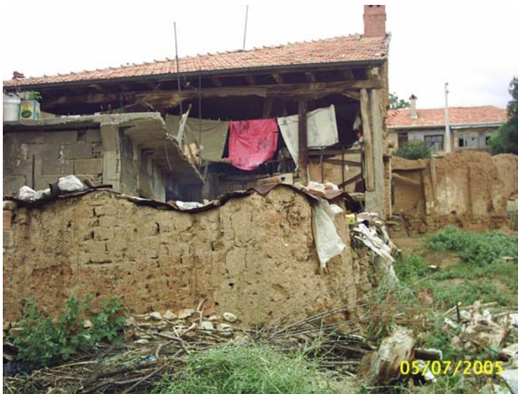
Resim 3.5. Mühtü Sokak'ta yer alan bir kısmı yıkılmış 156 envanter nolu yapı ve çevresindeki tanımsız, boş alanlar
