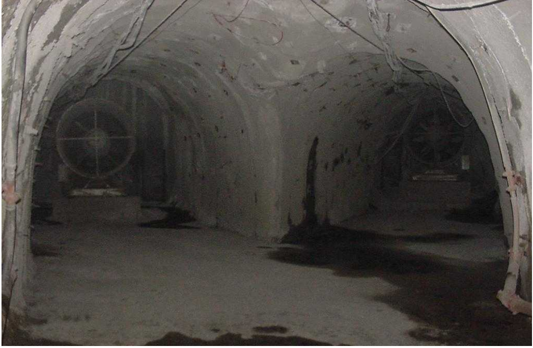
Foto 11. Yeraltı Havalandırma Fanları
