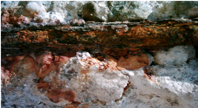
Resim 2.1. Betonarme çeliğinde korozyon
