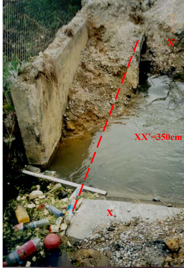
Şekil 4.2. Yüzey kırığının Arifiye girişinde su borularının 3.5 m ötelenmesine yol açan yanal atımı (Aydan et al., 2000).
