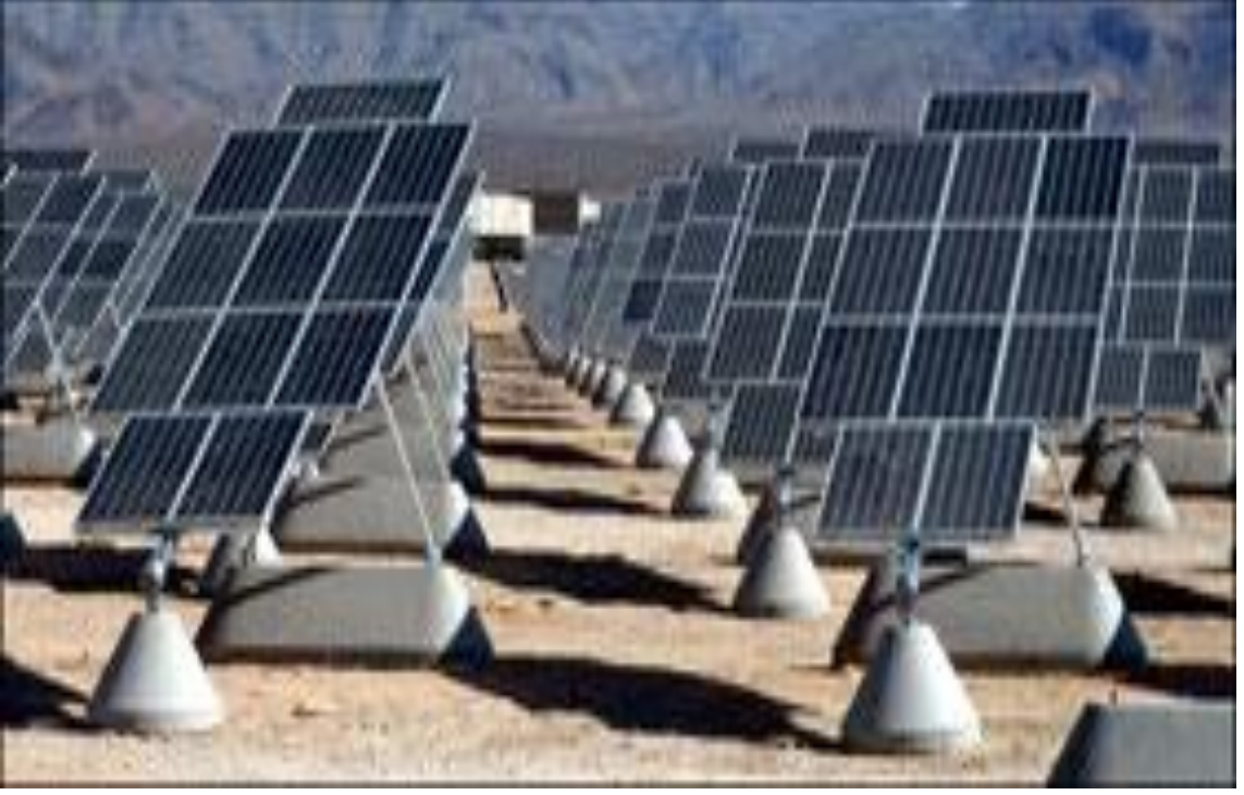
Şekil 1.4 Hareketli mekanizmaların kullanıldığı PV panellerden oluşan bir elektrik santrali
