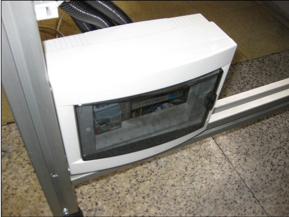
Şekil 5.54 : Elektrik sistemleri kontrol panosu.
