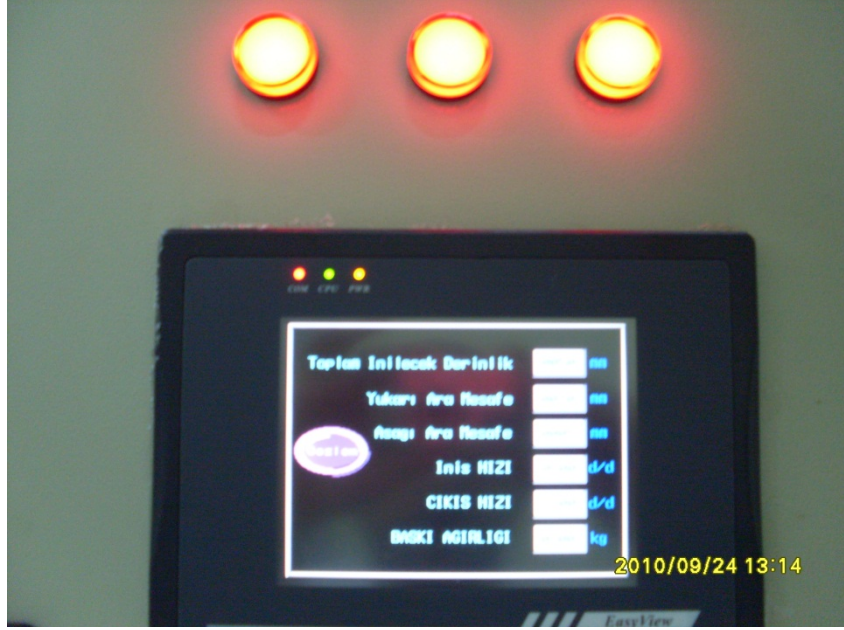
Şekil 5.2 Dokunmatik kontrol paneli
