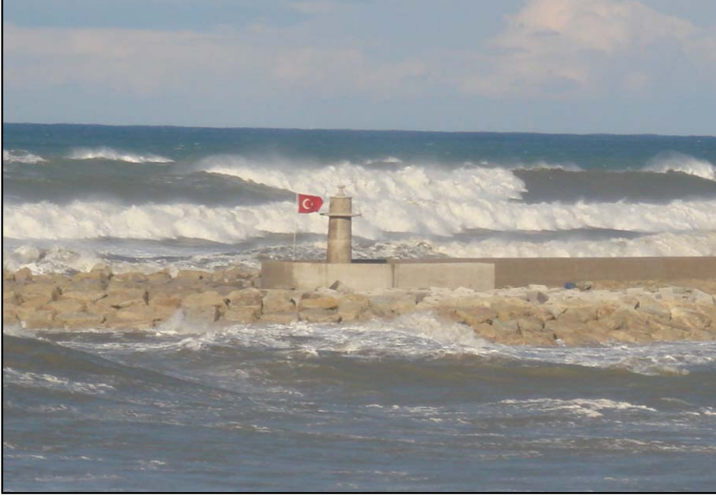
Şekil 1.3 11 Kasım 2007 fırtınasında Helaldı (Sinop) balıkçı barınağı ana dalgakıranı ve anroşmanların görünümü, kuzey'e bakış (Soydal, 2007)
