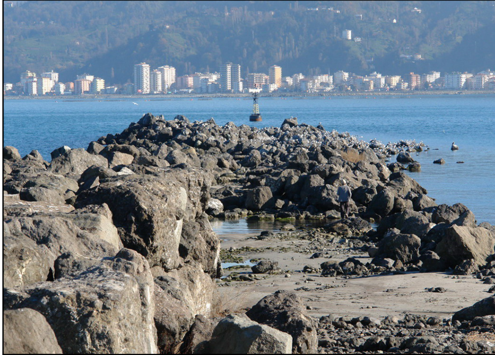
Şekil 1.2 Anroşman aşınmasına bağlı yapısal hasar Rize Limanı ana dalgakıranı, doğu'ya bakış)
