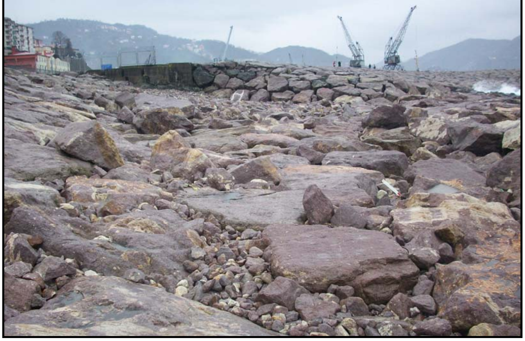
Şekil 4.13 Kovanlık anroşmanları ve Giresun Limanı'ndaki filtre katmanının yıkanmasına bağlı oturma (Batı'ya bakış)
