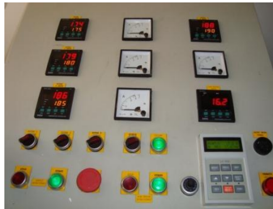
Şekil 4.4: Ekstruder kontrol paneli.
