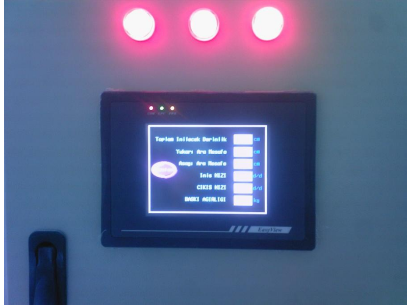
Şekil 5.2 Dokunmatik kontrol paneli
