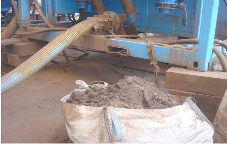
Resim 2. Demir grit atığı
