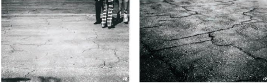
Őekil 3.26. Düşük ve orta derecede blok çatlaęı oluřumu (UFC, 2001)
