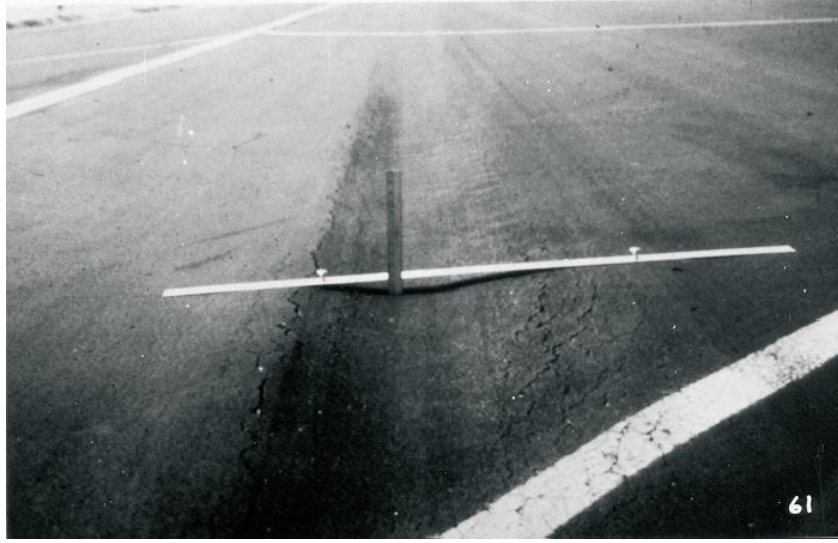
Şekil 3.28. Yüksek derecede tekerlek izi oluşumu (UFC, 2001)
