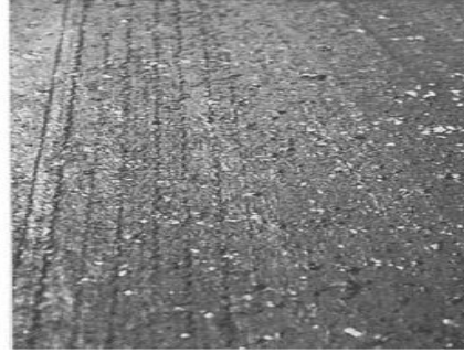
Şekil 3.38. Yüksek derecede kasma oluşumu (UFC, 2001)
