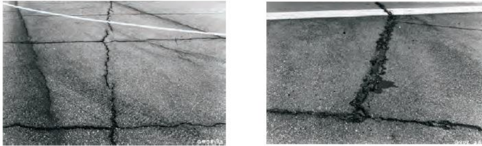
Şekil 3.32. Orta ve yüksek derecede yansıma çatlakları oluşumu (UFC, 2001)
