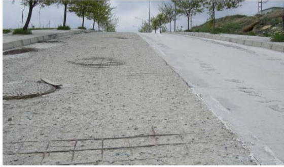
Şekil 2.18. Buzlanma mücadelesi sonucu bozulmuş beton yol (Bolat vd., 2010)
