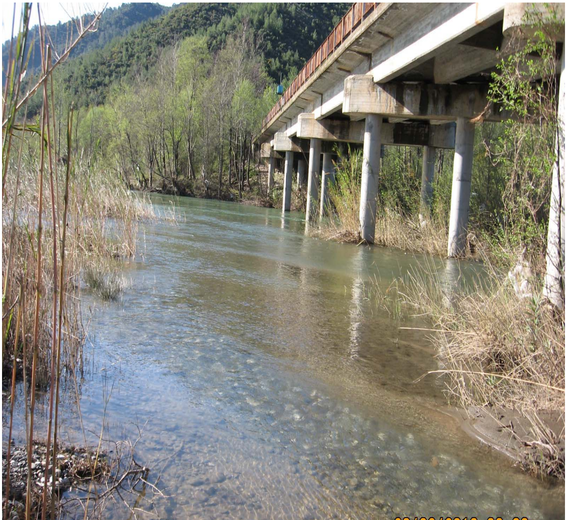
Şekil 3.12 3 nolu istasyonun görünüşü
