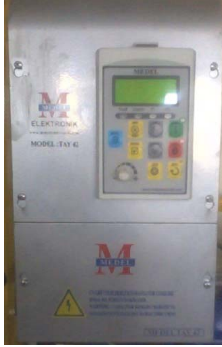
Şekil 4.12 İnvörtör ve kontrol paneli
