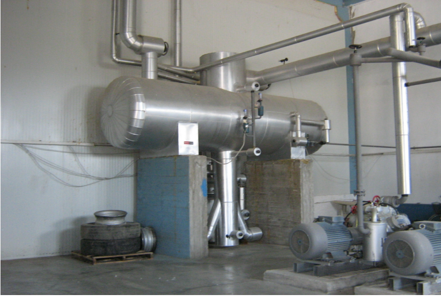
Şekil 4.21. İşletmelerin depolarında kullanılan amonyak gazlı soğutma sisteminin genel görünümü (Şarkikarağaç)
