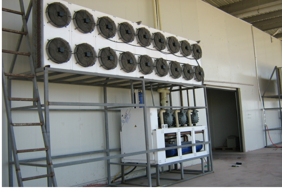
Şekil 4.23. İşletmelerin depolarında kullanılan freon gazlı soğutma sisteminin genel görünümü (Gelendost)
