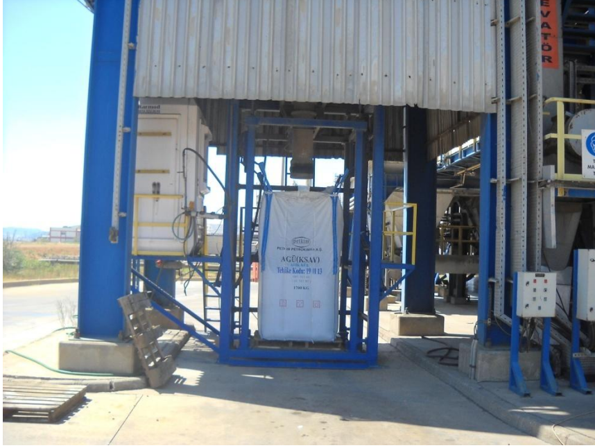
ŞEKİL 3: Tehlikeli atık yakma tesisi taban külü toplama sistemi
