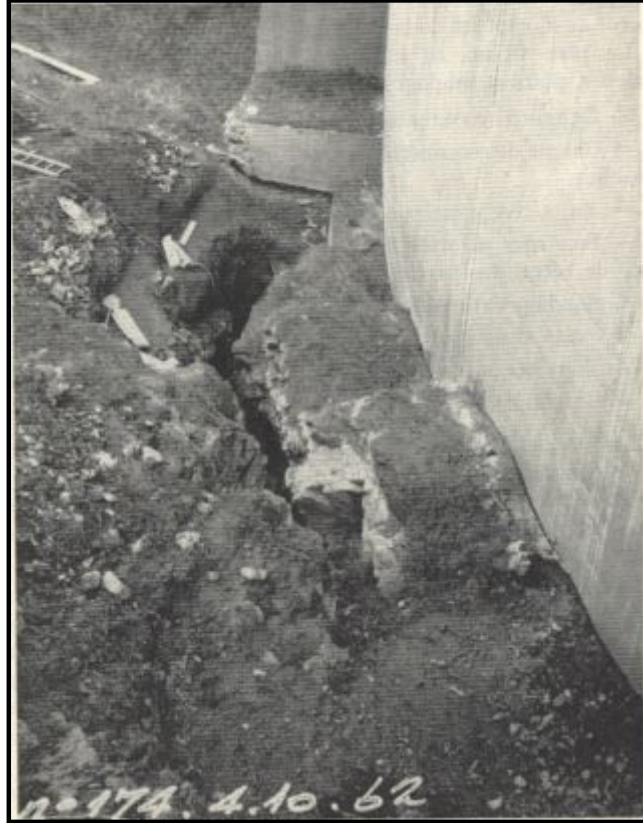
Şekil 1.13 Malpasset Barajı'nın memba topuğu yakınında basınç serbestlemesi nedeniyle açılan çatlak (Ertunç, 2003)
