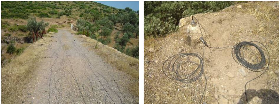
Şekil 5.77. İvmeölçerler ve veri toplama cihazı arasında iletimi sağlayan kablolar
