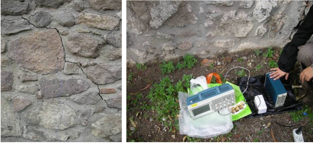
Şekil 5.88. Su kemerinin Kuzey yığma duvarındaki çatlak derinliğinin tespiti
