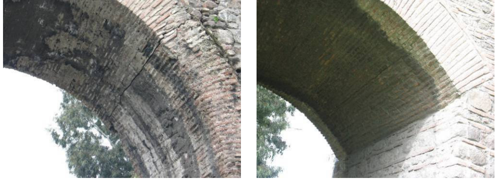
Şekil 5.7. Vezir Su Kemer kuzey tarafında bulunan ve kemer enince uzanan çatlaklar
