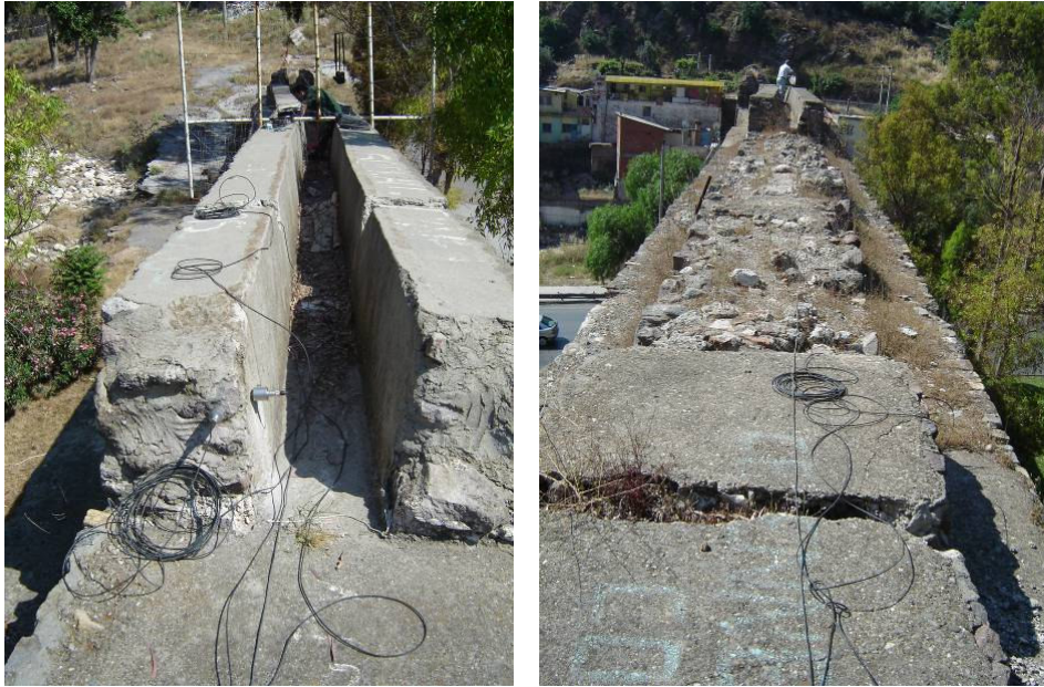
Şekil 5.67. İvmeölçerler ve veri toplama cihazı arasında iletimi sağlayan kablolar
