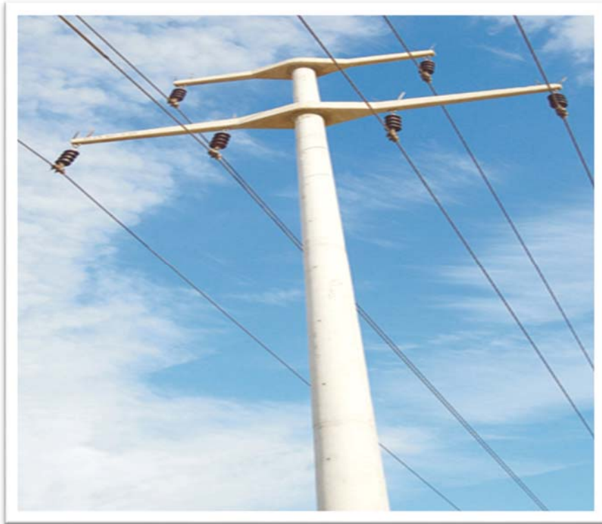
Şekil 3.6. Beton ENH direği örneği
