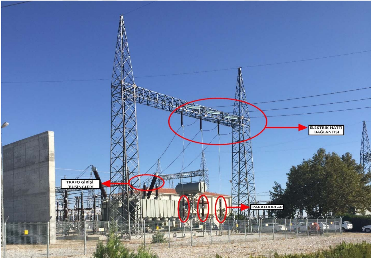
Şekil 4.16. KONYA 4 TM Güç trafosu parafudr bağlantısı
