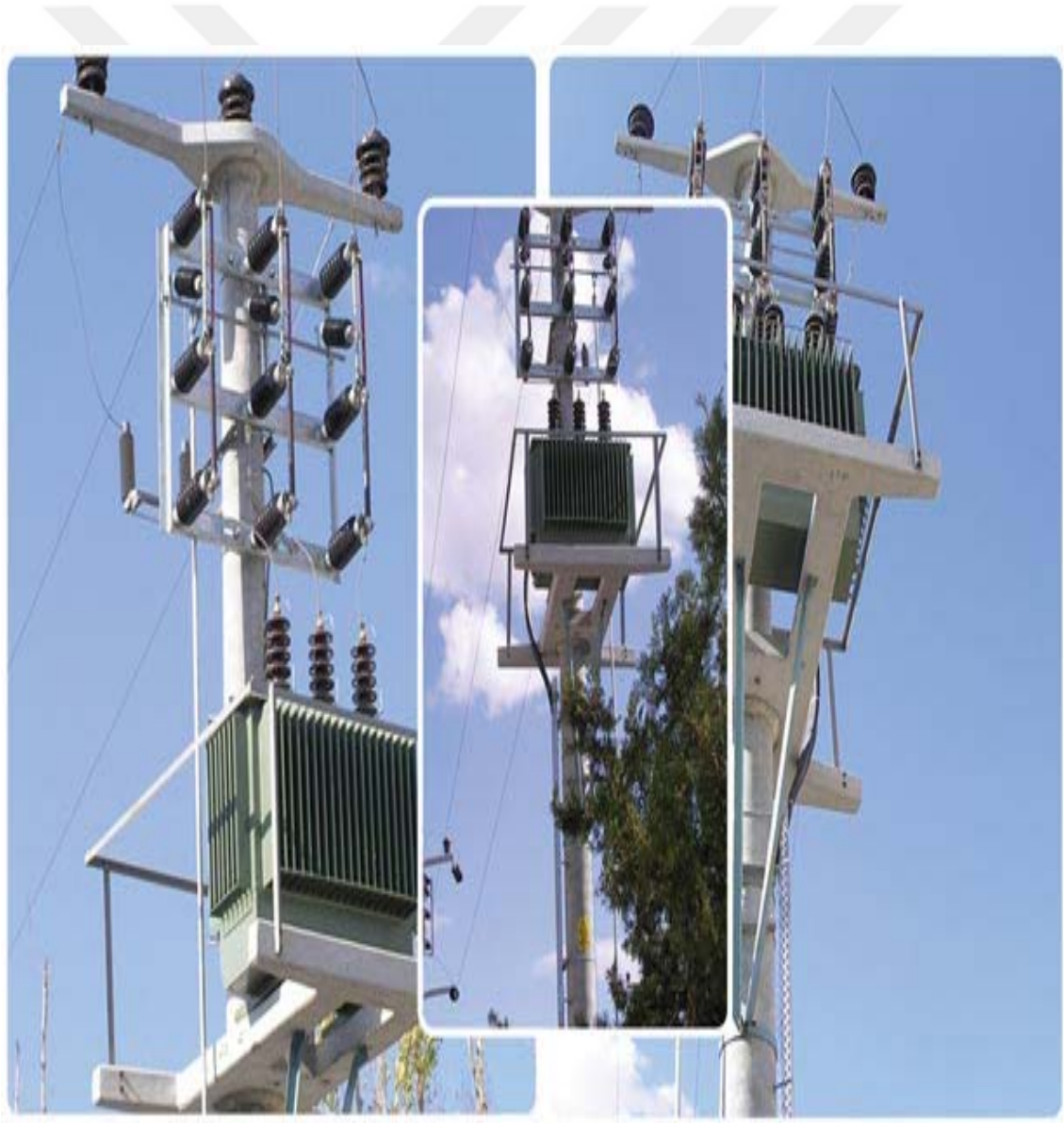
Şekil 3.7. Beton trafo direği (Betokav)
