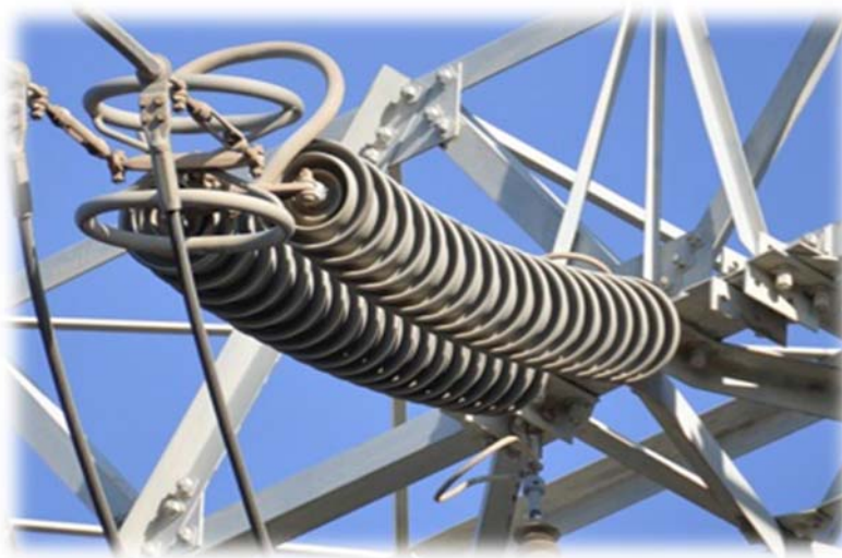
Şekil 3.15. Yüksek gerilim izolatör örneği
