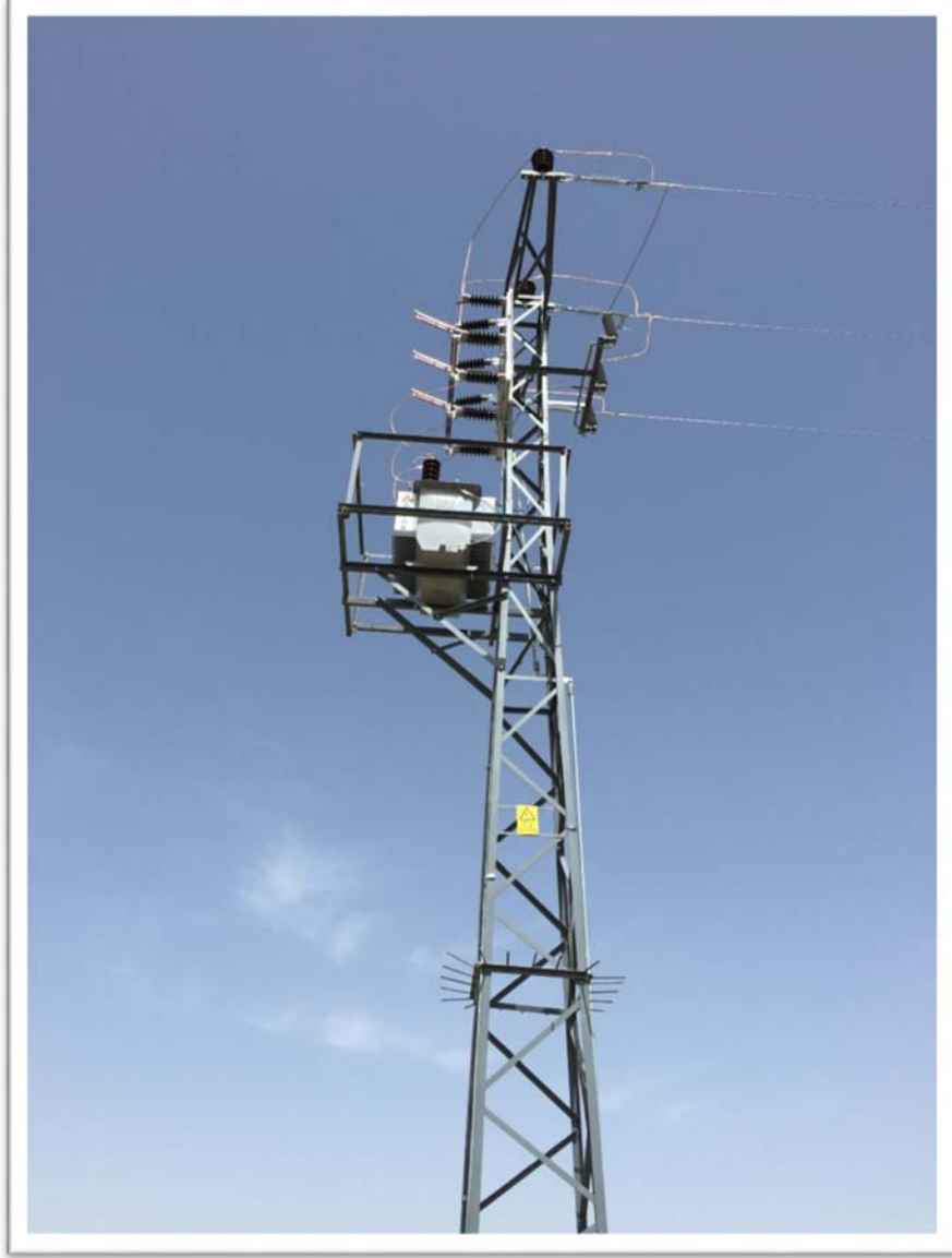
Şekil 3.1. Direk tipi trafo tesisi
